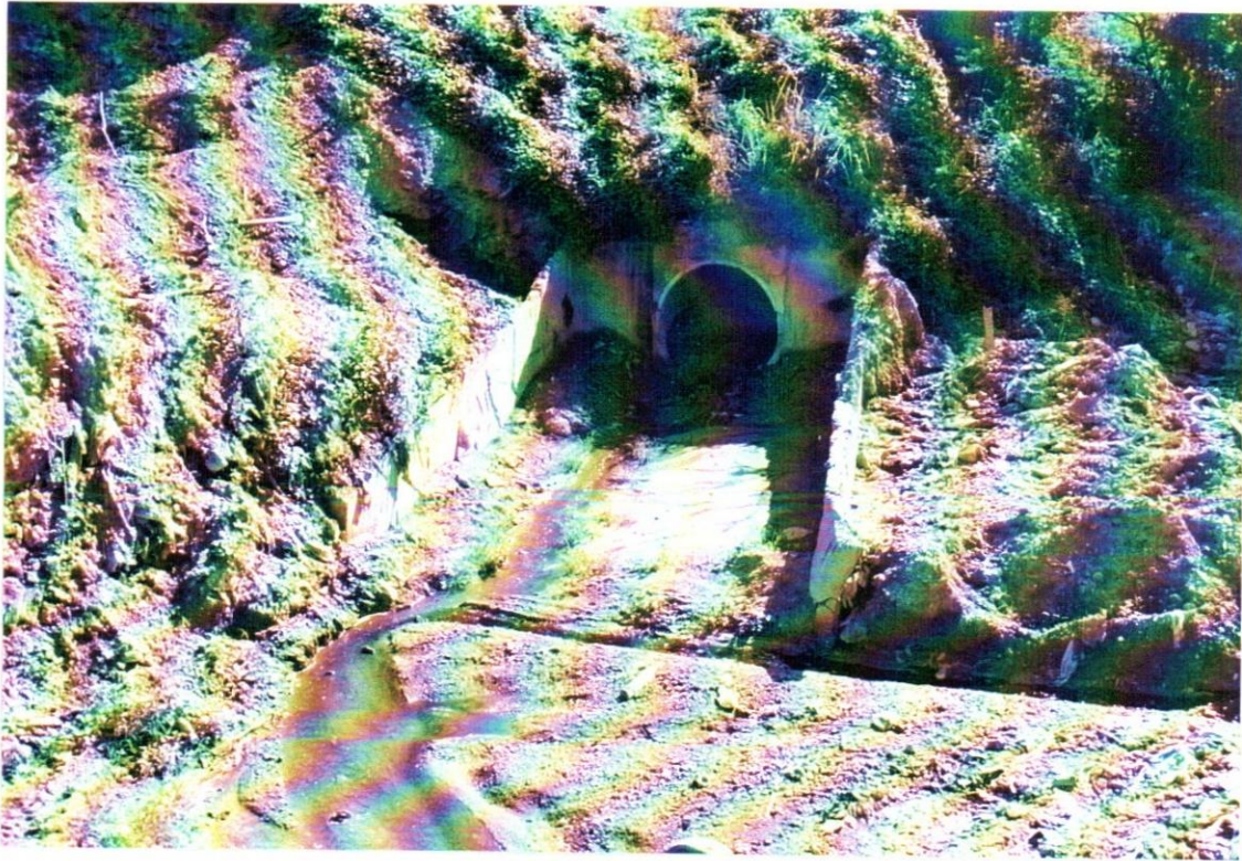
FOTO # 9 Descarga de la tubería recolectora de lixiviados.
