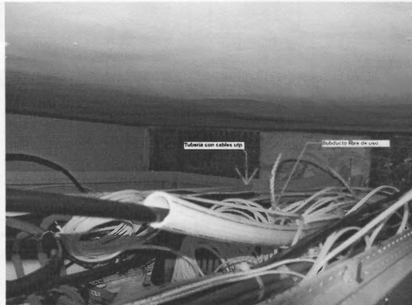
Foto 10. Izquierda subducto con cables utp/ Derecha subducto libre de uso. Ambos situados en la sala de fibra optica detrás del rack llamado Synfonet #1.
