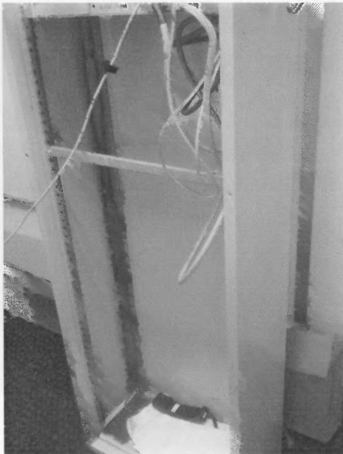
Foto 5. Rack libre de uso dentro del shelter.
