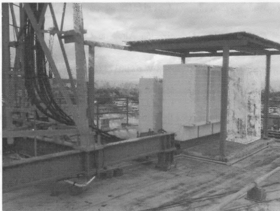
Foto 4. Espacio sugerido para nuevo rack outdoor.
