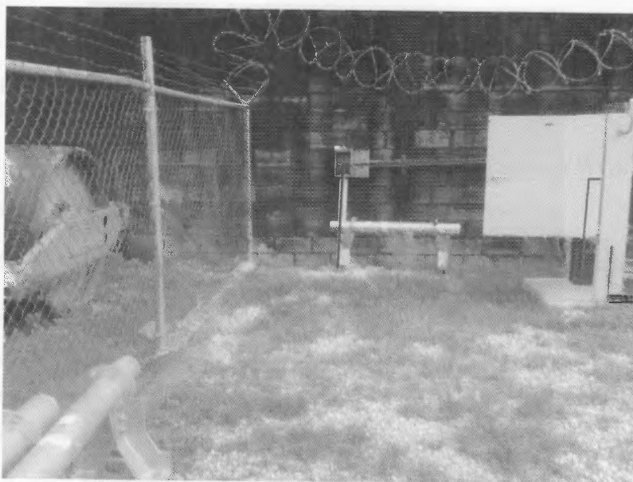
Foto 2. Detalle recorrido de tubería eléctrica ya dentro de la estación.
