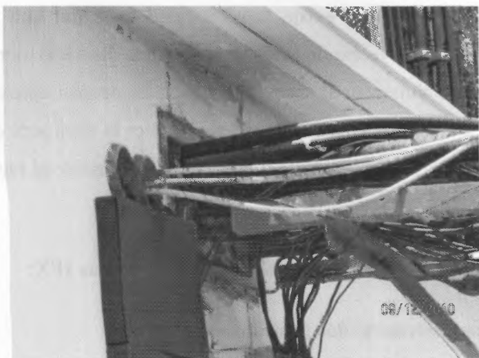
Foto 3. Boca pasa cable libre
