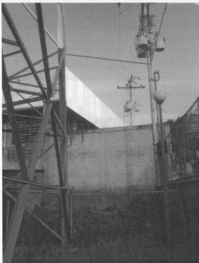
Foto 1. Poste de alta tensión que recibe la fibra. La fibra tendida hasta la torre y conducida hacia la escalerilla nueva.
