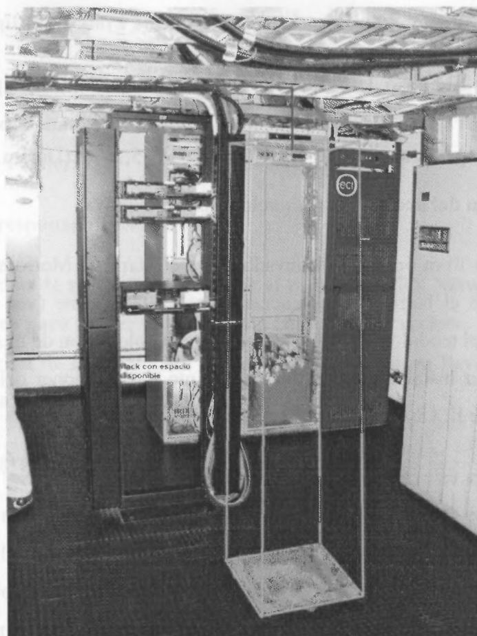
Foto 14. Espacio sugerido para rack nuevo en la sala de los Muxes. Nótese que detrás del rack sugerido hay otro con espacio disponible.
