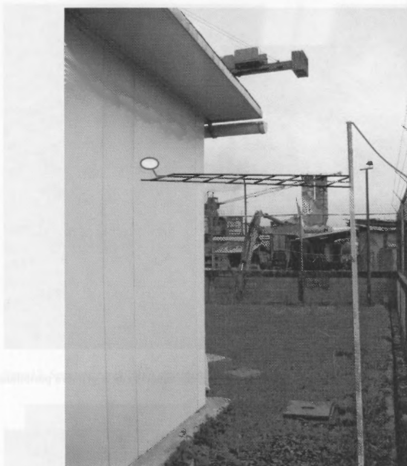
Foto 8. Poste nuevo no existente planteado en el escenario 2 y la primera posibilidad de instalar la escalerilla.
