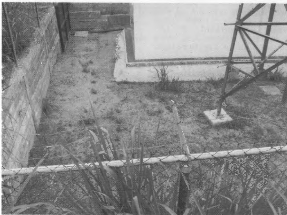
Foto 2. Tanquilla No 1 al final frente del portón de entrada a la estación (verde).
