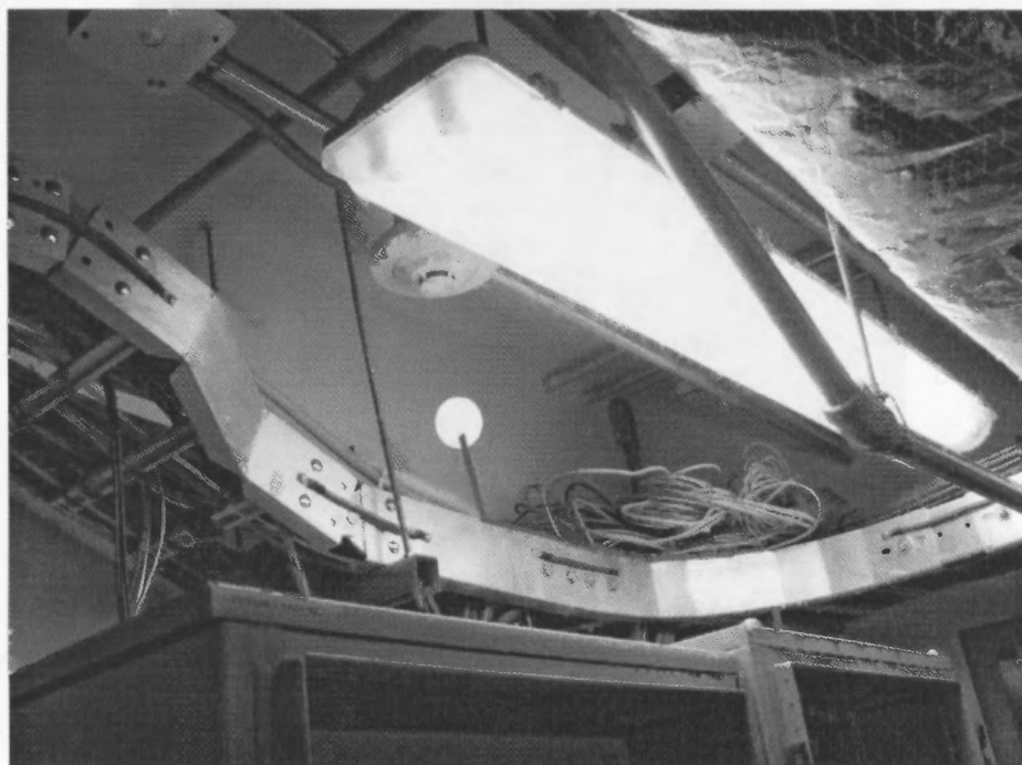
Foto 12. Escalerilla interna de la sala de fibra óptica. Boca pasacables sugerida para llevar la fibra a la sala de los Mux.
