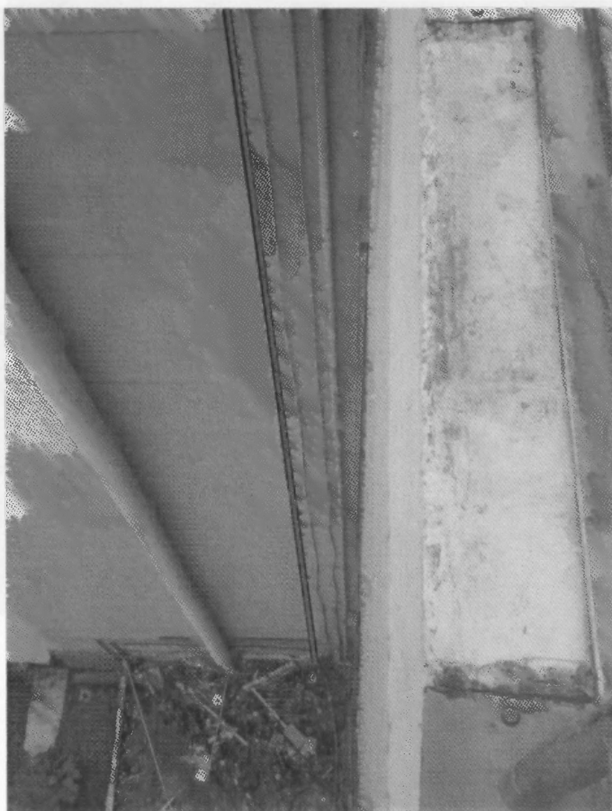
Foto 2. Tubería nueva no existente.
