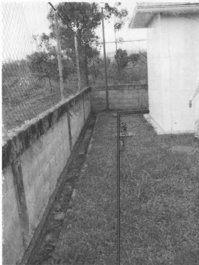
Foto 3. Detalle de ruta de la tubería eléctrica.
