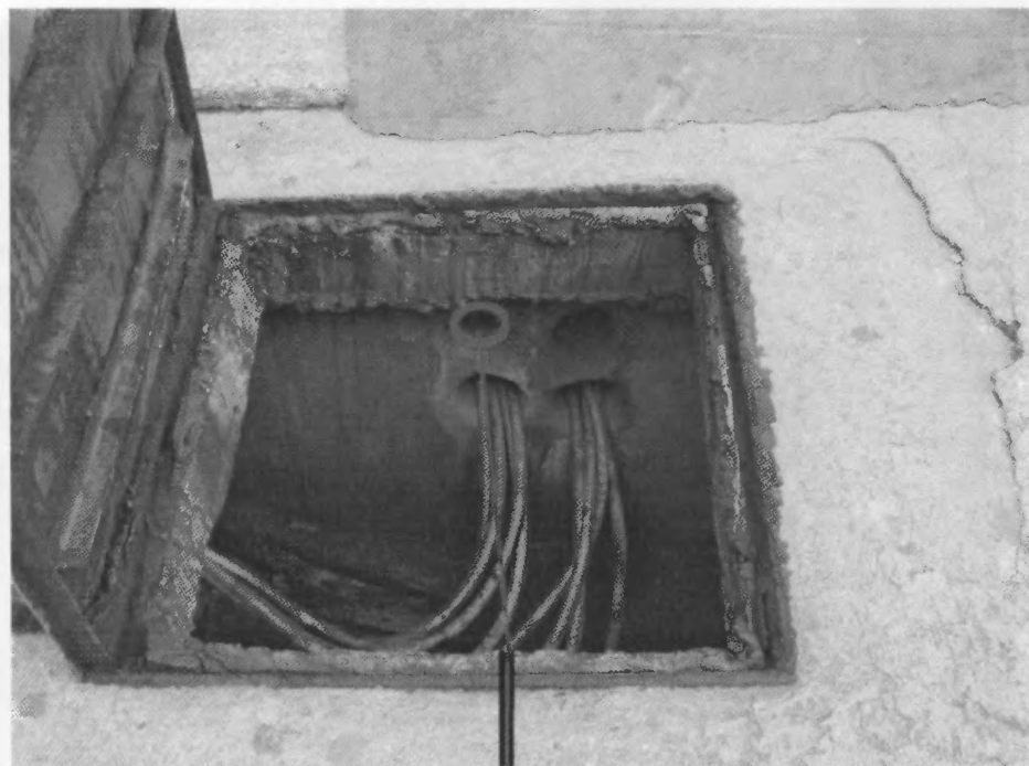
Foto 4. Tanquilla No 1 Se observan dos ductos de 4" libres hasta la próxima tanquilla.
