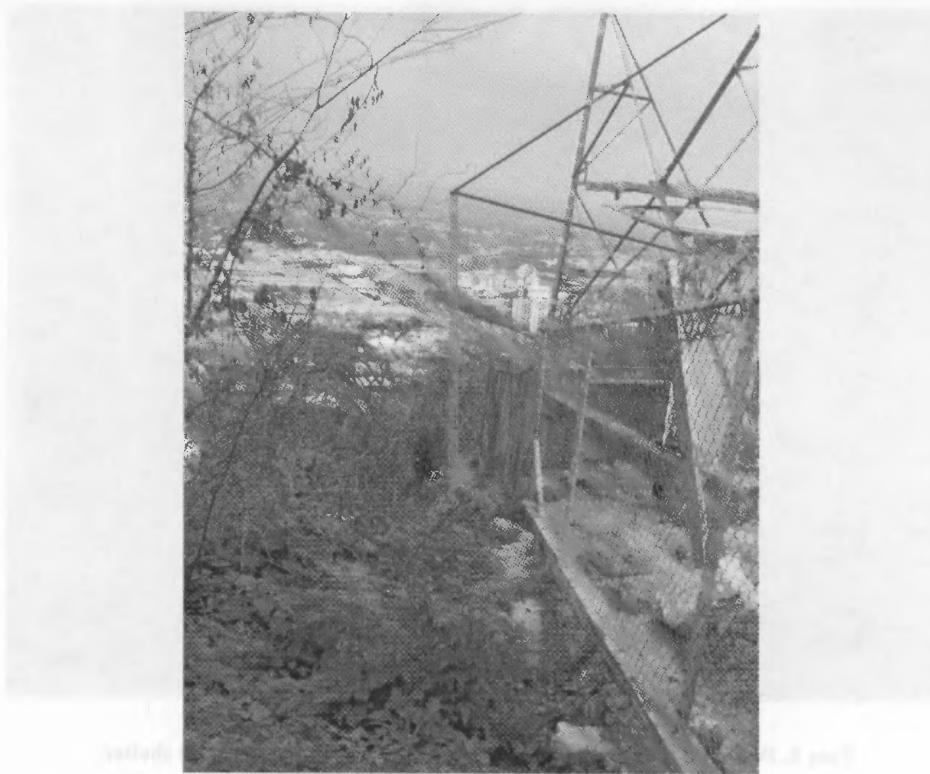
Foto 3. Poste número 3 inexistente a colocar.
