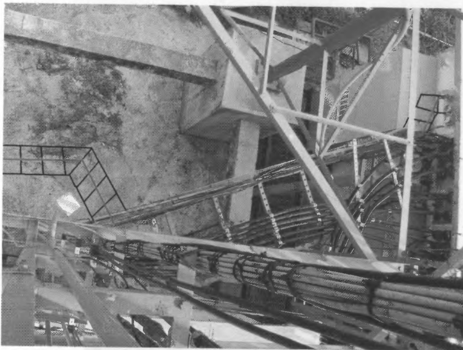
Foto 5. Detalle de la escalerilla proveniente del poste 3 y acceso al shelter.
