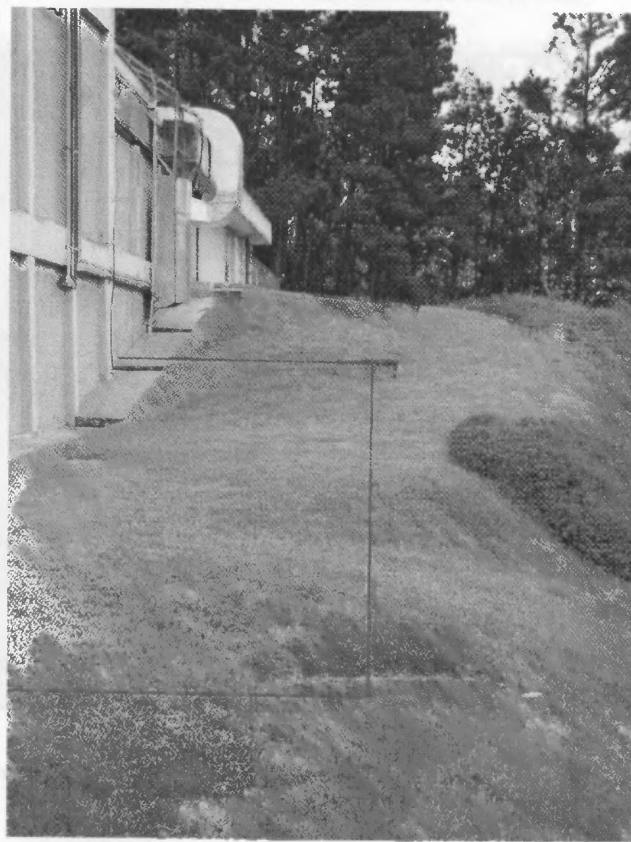
Foto 9. Recorrido de la tubería y acceso al recinto.
