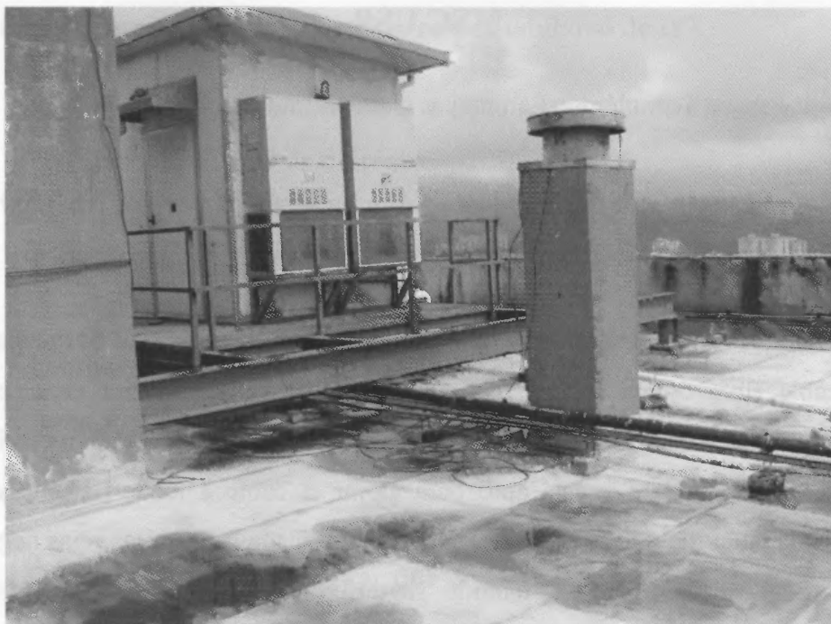
Foto 10. Canalización hacia el shelter, entra por debajo hasta el tablero de electricidad.
