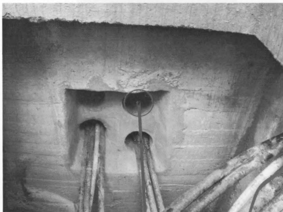
Foto 5. Tanquilla No 2 se observa que existen dos tubos libres de 4" que vienen de la Tanquilla No 1.
