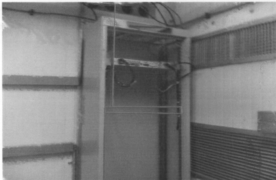
Foto 3. Gabinete con espacio disponible para colocación de equipos.
