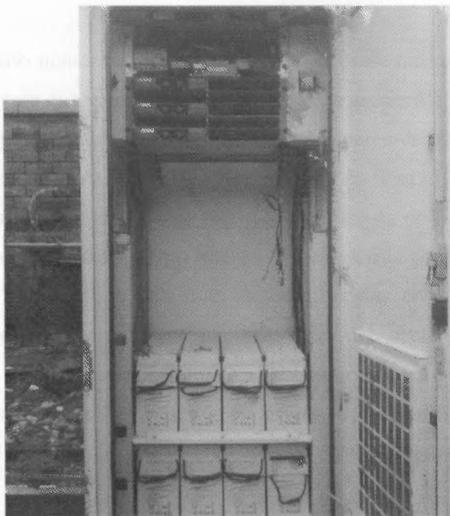
Foto 3. Rack outdoor con espacio disponible.
