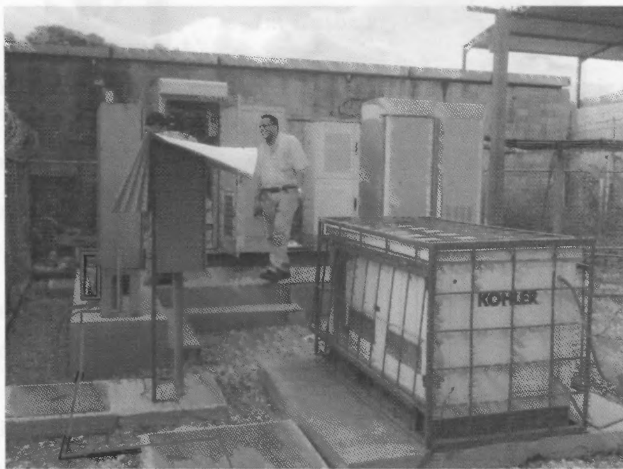
Foto 2. Detalle del recorrido de la ductería hasta el tablero eléctrico.
