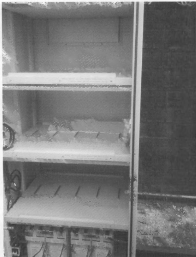
Foto 4. Espacio en Rack.
