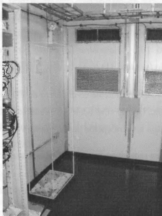
Foto 11. Espacio donde supuestamente pudiera ir un rack para colocar la fibra y los equipos.
