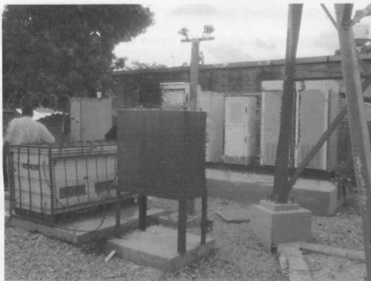
Foto 4. Vista general de la estación Turmero.
