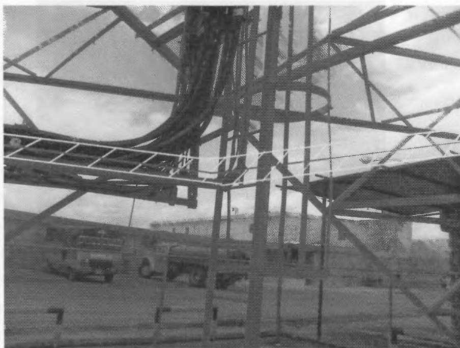
Foto 4. Detalle de la escalerilla para ingresar al shelter.
