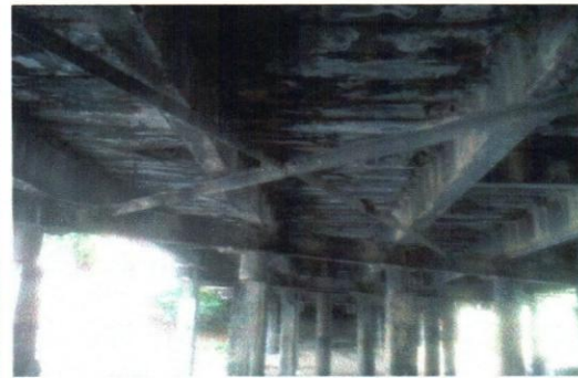
Deterioro del acero estructural
