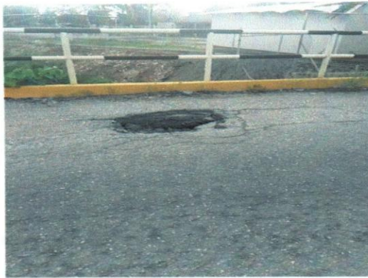
Deterioro de la carpeta de rodamiento
