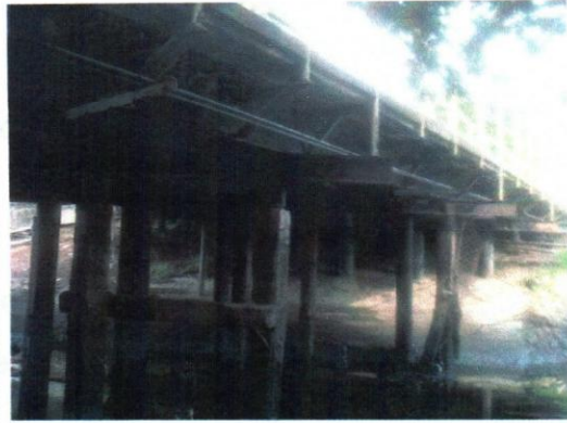
Deterioro general de la estructura
