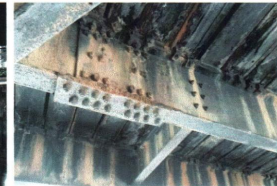
Corrosión en juntas metálicas
