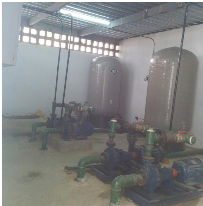
Anexo N°35: Cuarto de bombas. Fuente propia. Fecha 13 de Abril del 2016
