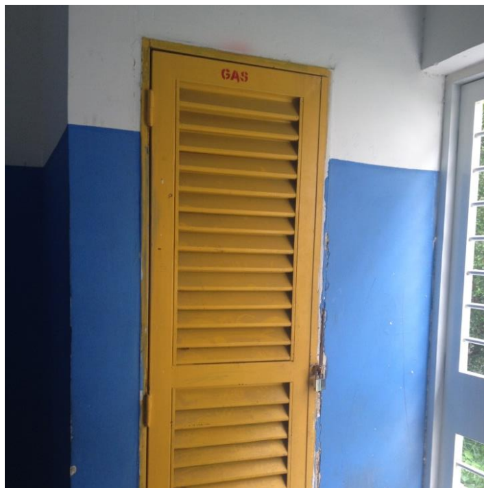
Anexo N°29: Cuarto de Gas PB. Fuente propia. Fecha 6 de Abril del 2016
