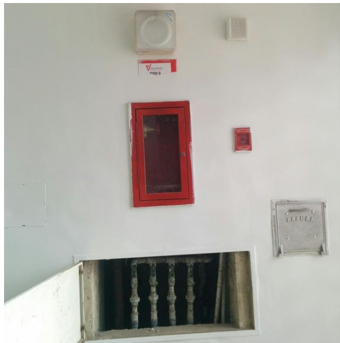
Anexo N°31: Bajante de basura, tuberías, sistema de prevención de incendio, Fuente propia. Fecha 13 de Abril del 2016
