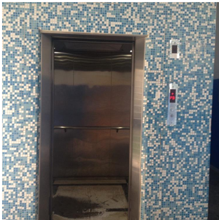
Anexo N°26: Vista del ascensor PB. Fuente propia. Fecha 6 de Abril del 2016
