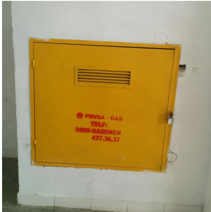
Anexo N°30: Gabinete de gas en pisos. Fuente propia. Fecha 6 de Abril del 2016
