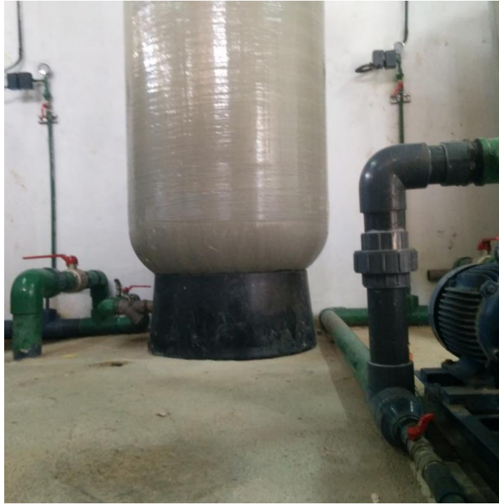
Anexo N°36: Cuarto de bombas. Fuente propia. Fecha 13 de Abril del 2016
