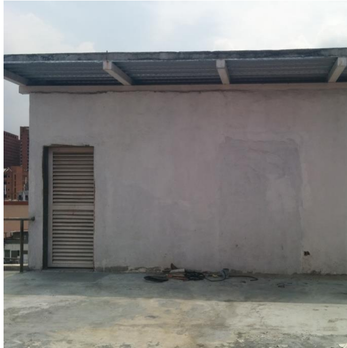
Anexo N°42: Techo, cuarto del ascensor. Fuente propia. Fecha 13 de Abril del 2016
