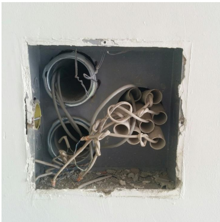
Anexo N°34: cableado de telefonía. Fuente propia. Fecha 13 de Abril del 2016
