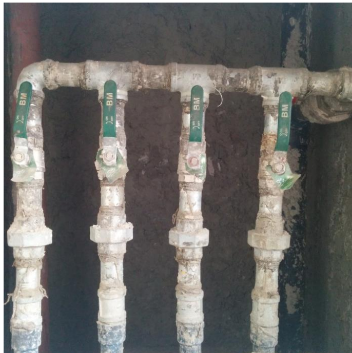
Anexo N°32: Tuberías Aguas Blancas, Montante e Incendio. Fuente propia. Fecha 13 de Abril del 2016
