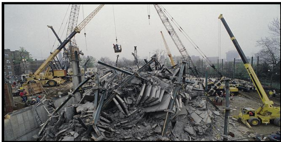
Figura II-9: Edificio L' Ambience Plaza en Bridgeport, Connecticut luego del colapso
