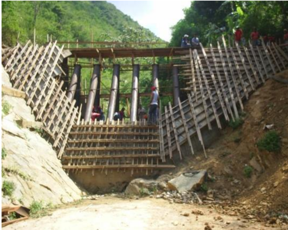
Figura A. 11 - Proceso constructivo de la Presa Abierta tipo Rastrillo en el afluente "B" de la Qda. Tacagua
