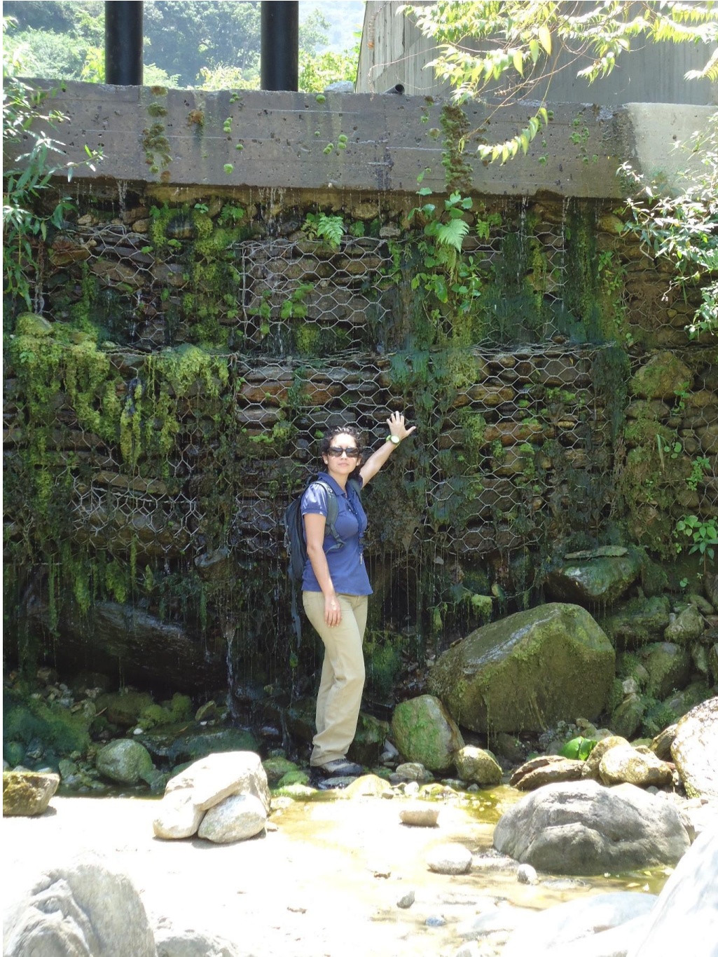
Figura A. 5 - Parte de la fundación de gaviones de la Presa Abierta de Camuri Chico
