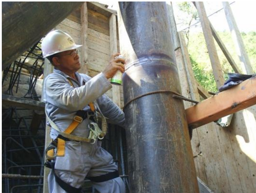
Figura A. 12 - Tubo de Acero que forma parte de la Presa Abierta tipo Rastrillo del afluente "B" de la Qda. Tacagua
