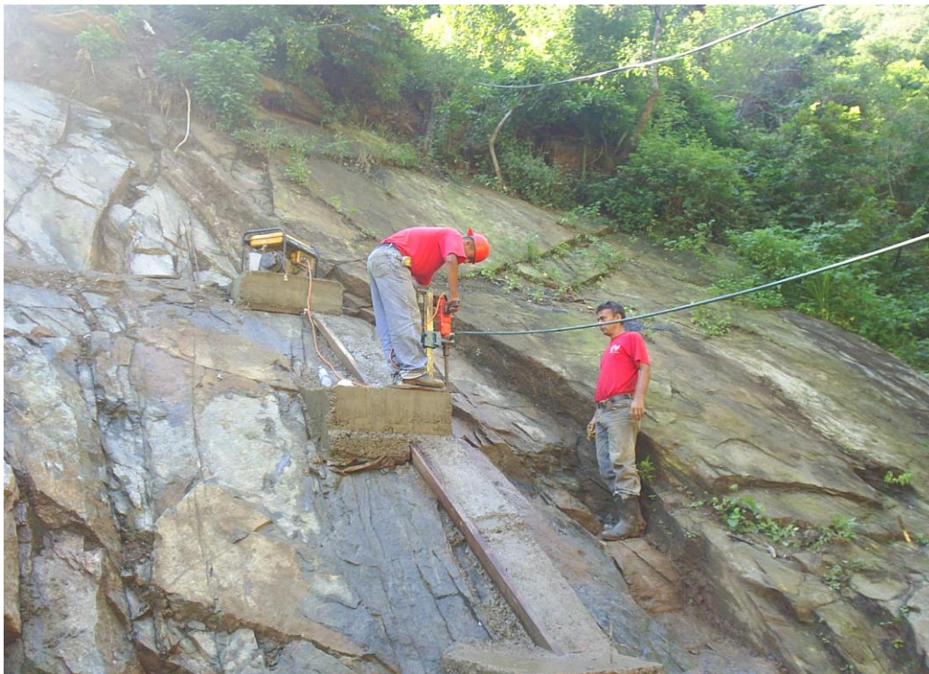
Figura A. 10 - Proceso constructivo de la Presa Abierta tipo Rastrillo en el afluente "B" de la Qda. Tacagua
