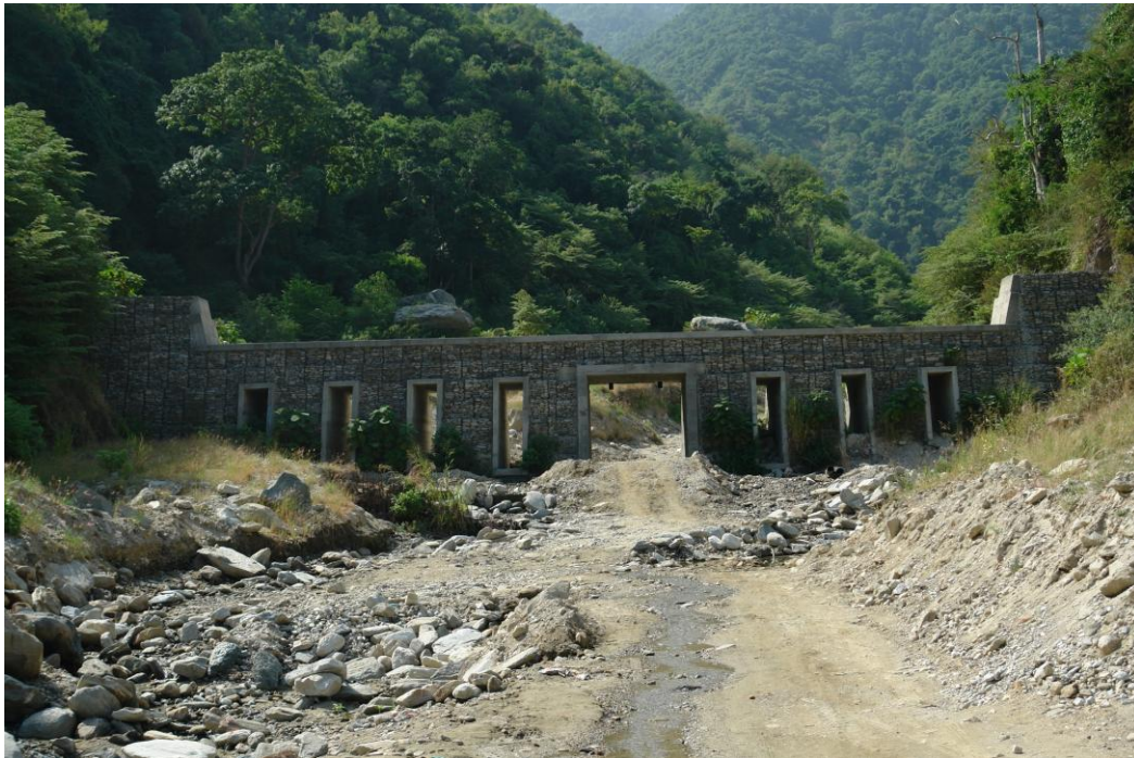
Figura A. 1 - Vista frontal hacia aguas arriba de la Presa Abierta de Camuri Chico
