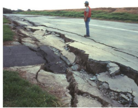
Figura 25. Fotografía del daño causado a una vía por una extensión lateral producto de un terremoto, en California, Estados Unidos
