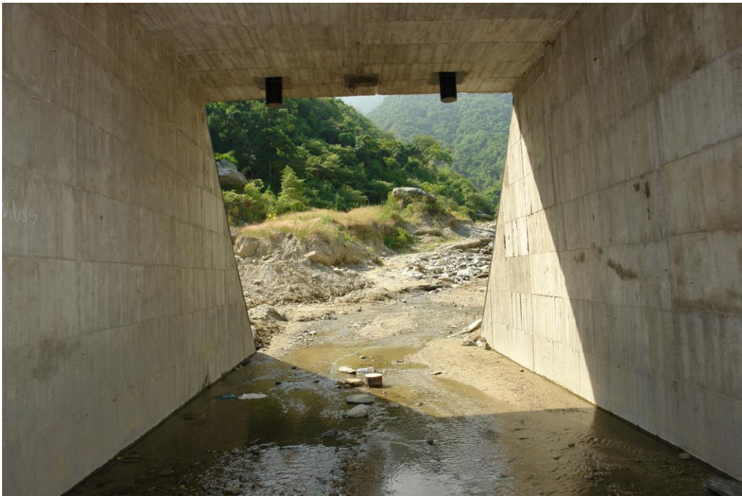
Figura A. 4 - Vista hacia el interior del cajón central de acceso para maquinaria donde se observan los niples para los tubos de acero removibles. También se aprecia la inclinación del talud aguas arriba de la presa.
