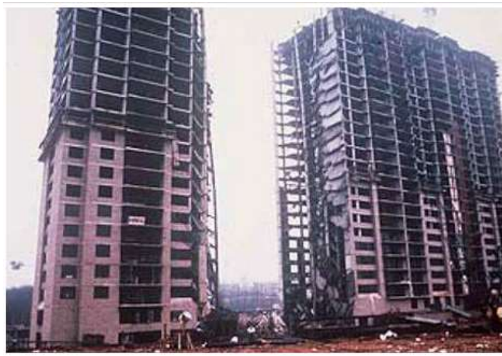
Figura II-10. Complejo de apartamentos Skyline Plaza luego del colapso. Tomada de http://www.masterbuilder.co.in/formwork-failure-cases-causes/
