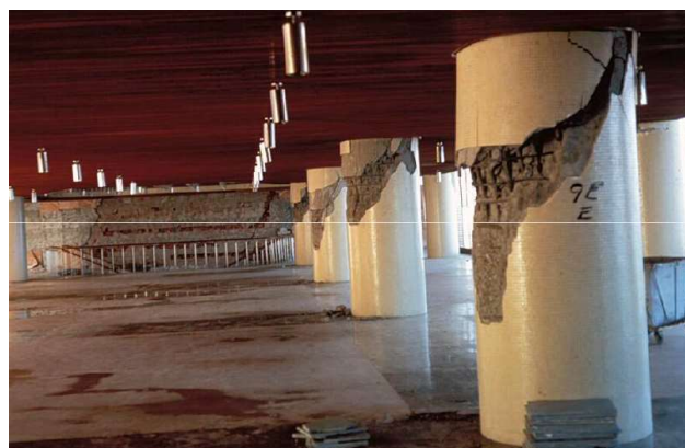
Figura II-12. Falla de Columnas a corte en Hotel Macuto Sheraton. Tomada de “Costruzioni in Zona Sismica”. Spacone, E., 2009.
