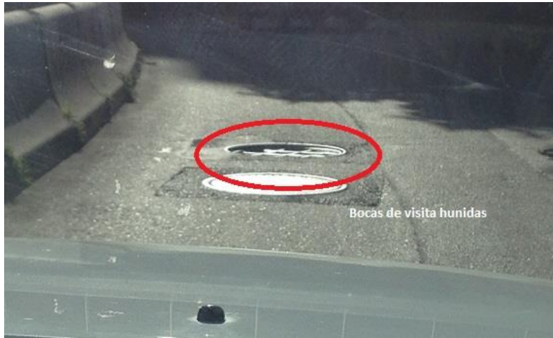
Foto 3: Mal estado de drenajes y bocas de visita.
