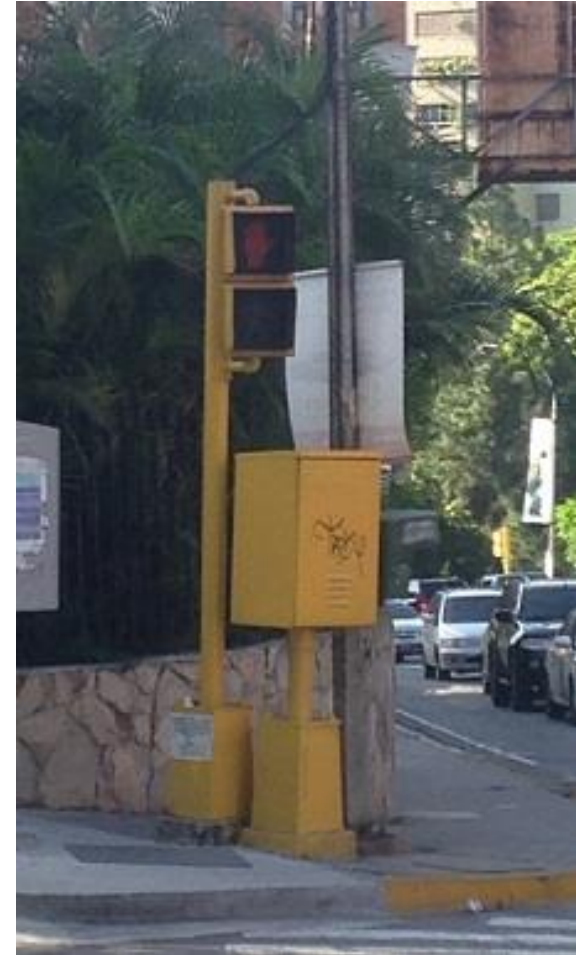
Foto 2: semáforos de peatones dañado, esto se presenta en varias intersecciones de los tramos estudiados.
