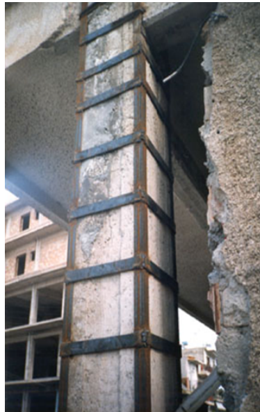
Figura 6. Placas Metálicas en columna. Fuente: Internet
