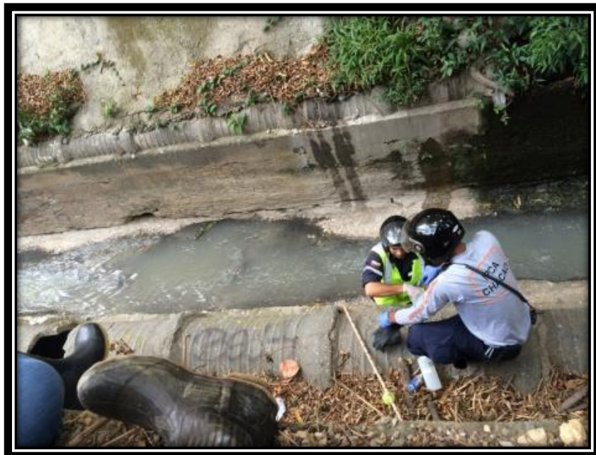
Canalización a la altura de la Urbanización Sans Souci
