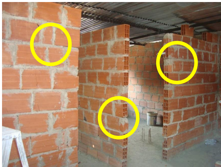
Figura 6-2. Distribución interna de paredes en mampostería de vivienda ubicada en el barrio Chapellín, Municipio Libertador. Se evidencia el uso del mortero para rellenar las fracturas o quiebres de los bloques. (Fuente: Propia).
