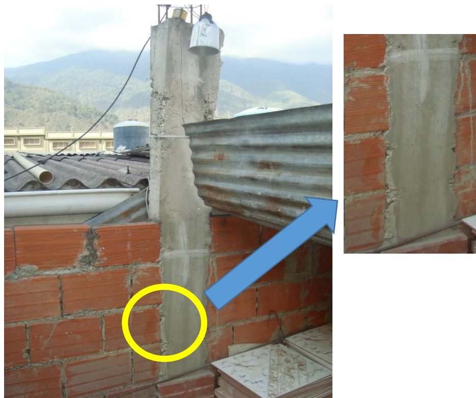
Figura 6-3. Azotea de vivienda ubicada en el barrio Chapellín, Municipio Libertador, Caracas. Se observa el concreto del machón escurrido entre los bloques. (Fuente: Propia).
