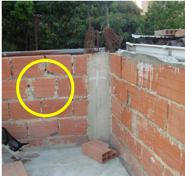
Figura 6-1. Azotea de vivienda ubicada en el barrio Chapellín, Municipio Libertador. Se evidencia la superposición de bloques fracturados. (Fuente: Propia).
