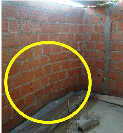
Figura 6-6: Vivienda ubicada en el Barrio Chapellín, Municipio Libertador. Se resalta una pared externa desalineada producto de error en mano de obra. (Fuente: Propia).
