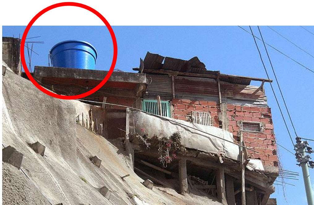
Figura 5-7: Tanque de agua elevado, dispuesto sobre vivienda de mampostería confinada. Barrio La Bombilla de Petare. (Foto: Eneko Etxebarrieta, 2008).
