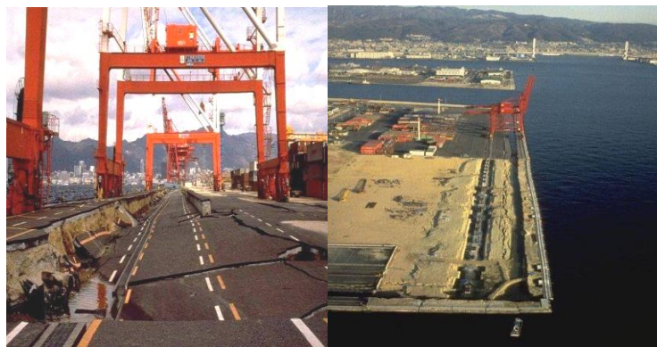
Fotos 1. Desplazamiento lateral de un muro del muelle en el Puerto Isla, Kobe 1995. Fuente: University of Washington (2000)
