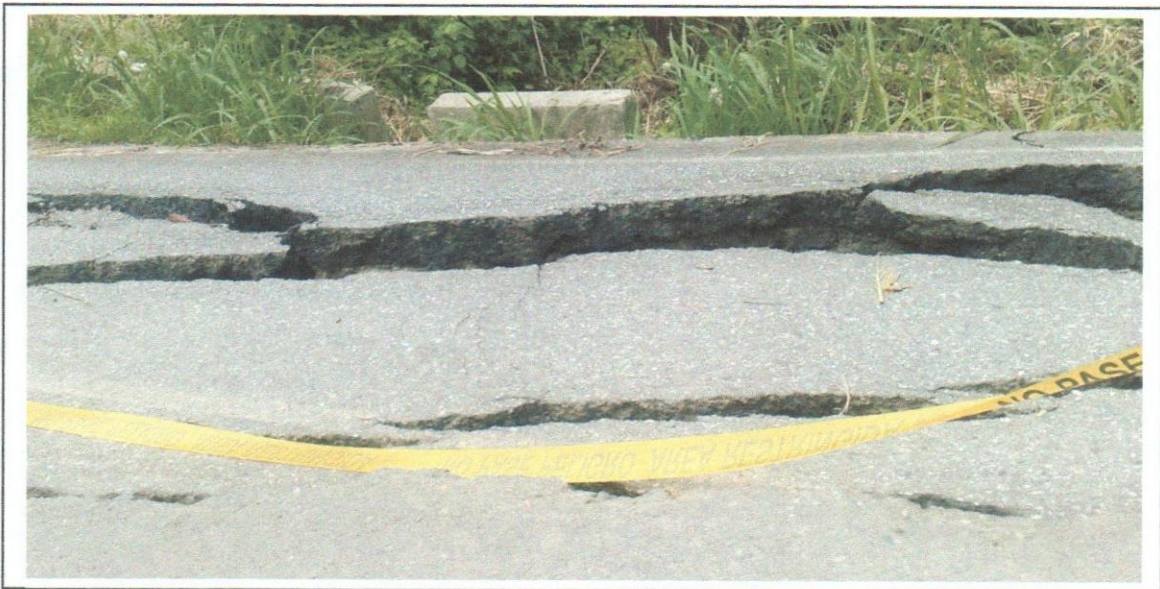
Figura Anexo 6. Fallas de borde en las vías de acceso que conducen hacia "La Palmita", Municipio Alberto Adriani, Mérida, Edo. Mérida. Mayo 2011.
