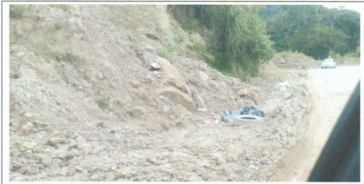
Anexo 7. Derrumbes en las vías de acceso que conducen hacia "La Palmita", Municipio Alberto Adriani, Mérida, Edo. Mérida. Mayo 2011.
