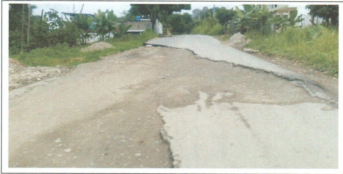
Anexo 5. Vías de acceso en mal estado que conducen hacia "La Palmita", Municipio Alberto Adriani, Mérida, Edo. Mérida. Mayo 2011.
