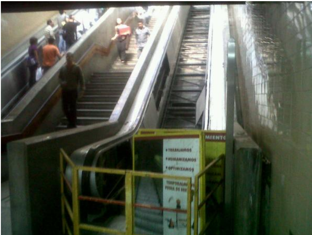
Escaleras mecánicas del Metro de Caracas dañadas. Cortesía @CaracasMetro
