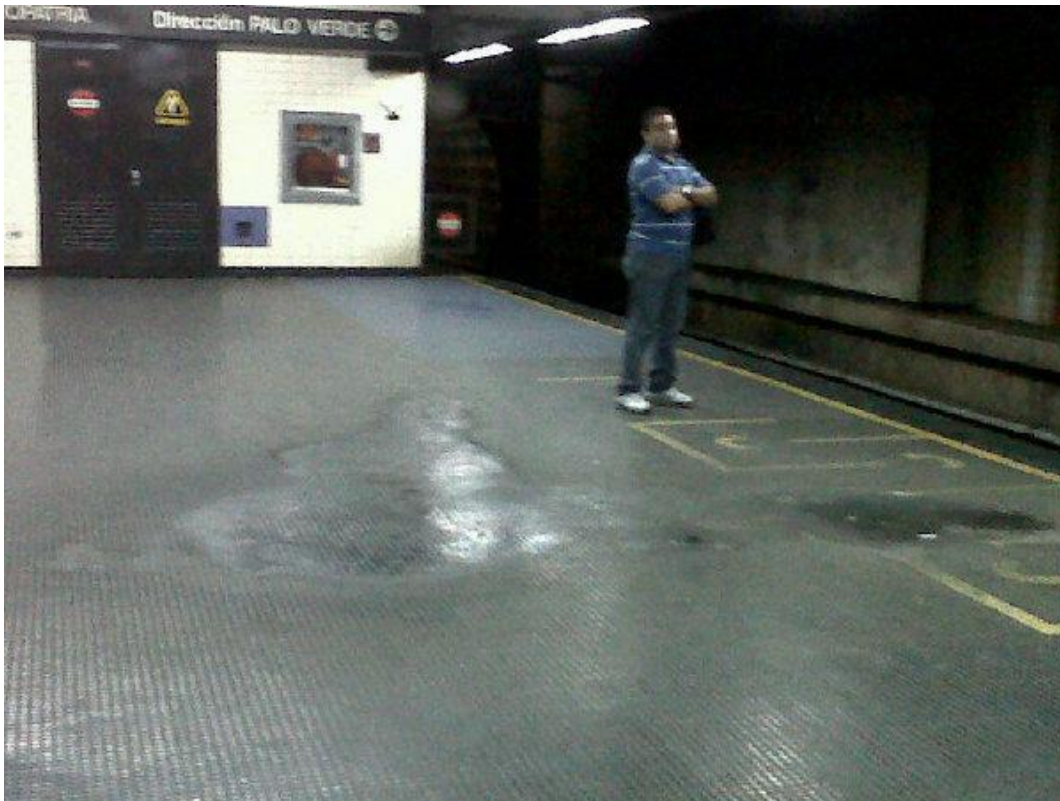
Gotas en el techo de la estación Pérez Bonalde. 9 septiembre de 2010. Cortesía @CaracasMetro
