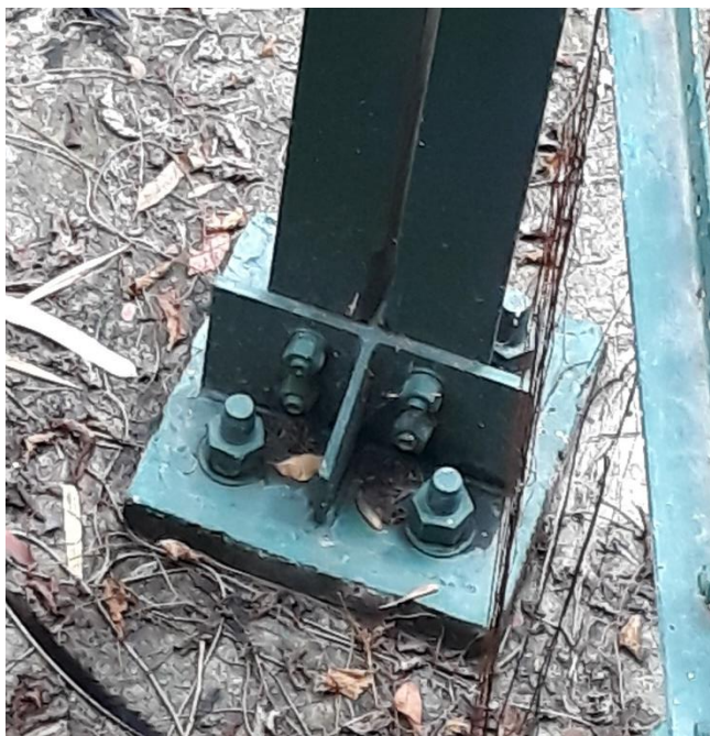
Figura 30. Placa base 3 Fuente: Foto Propia
