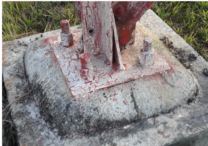
Figura 35. Placa Base apoyada sobre grout Fuente: Foto Propia
