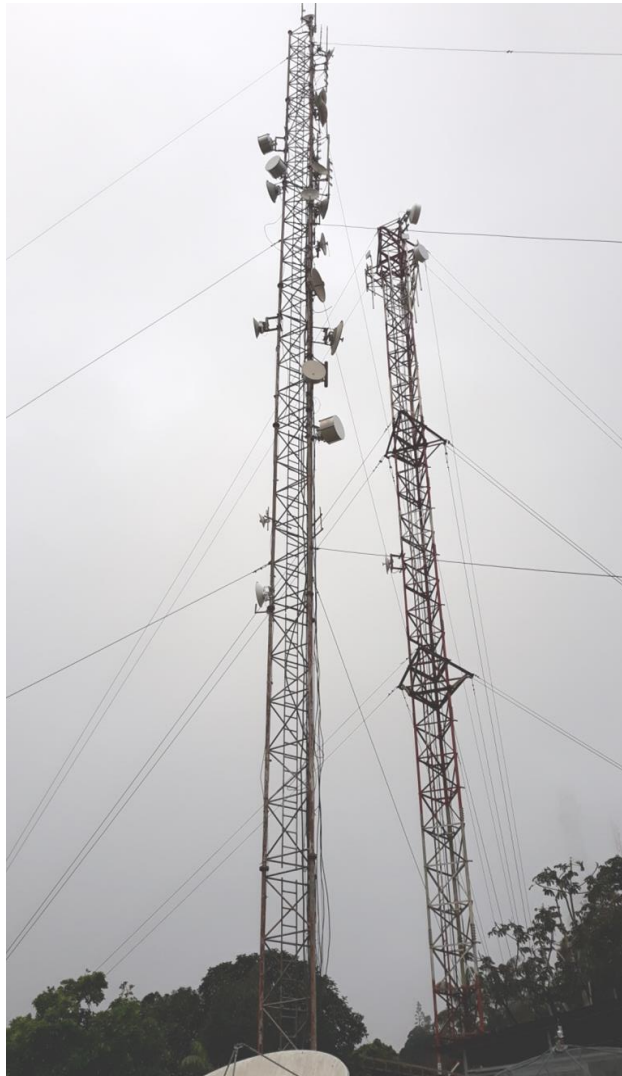
Figura 11. Torres arriostradas Fuente: Foto propia
