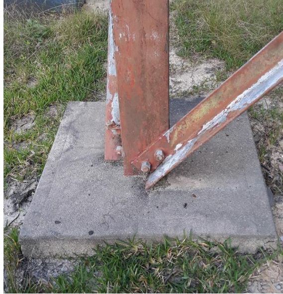
Figura 37. Placa base y anclajes embutidos Fuente: Foto Propia
