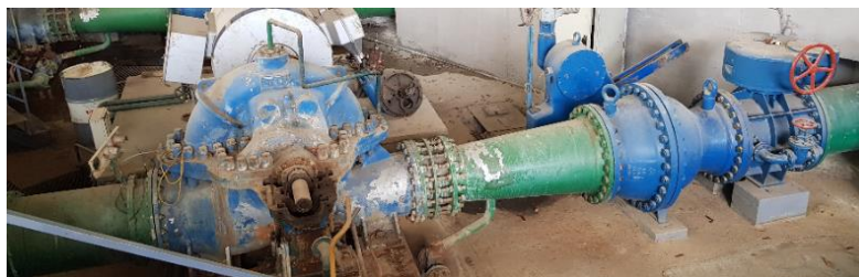
Figura N°42. Ramal de bombeo número 2, grupos Norte E/B 25.
