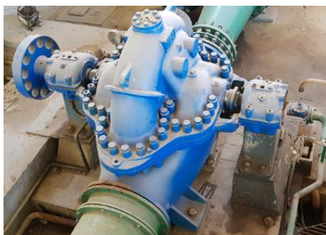
Figura N°34. Bomba centrífuga KSB RDL 500-71L del grupo de bombeo Norte.
