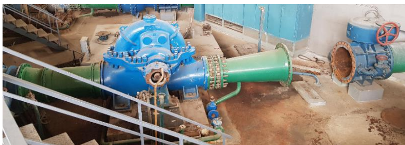
Figura N°44. Ramal de bombeo número 3, grupos Norte E/B 25.
