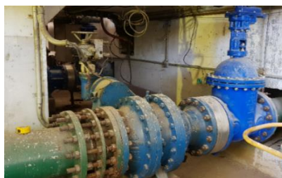
Figura N°53. Válvulas de paso anular y compuerta del ramal número 1, grupos Sur E/B 25.
