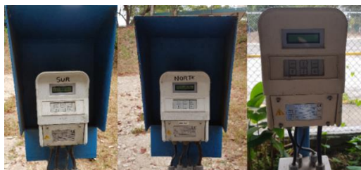
Figura N°32. Medidores de caudal de los Alimentadores Sur, Norte y Este respectivamente.
