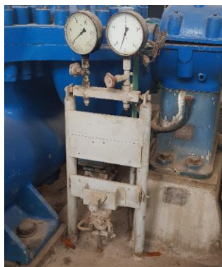
Figura N°43. Manómetros de la bomba centrífuga del ramal número 3.
