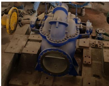
Figura N°35. Bomba centrífuga KSB RDL 400-540A del ramal 4 del grupo de bombeo Norte.
