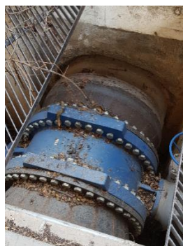
Figura N°57. Válvula mariposa conocida como la “Compuerta del Este” que da inicio al Alimentador Este.
