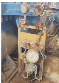
Figura N°41. Manómetros de la bomba centrífuga del ramal número 2.
