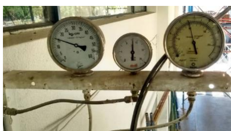
Figura N°28. Manómetros del centro de control, de izquierda a derecha: Grupo Sur, múltiple de succión y Grupo Norte.
