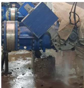
Figura N°54. Filtraciones de agua de la válvula de paso anular del ramal número 5.
