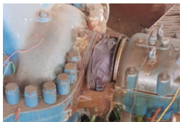
Figura N°39. Fuga de agua en la bomba centrífuga del ramal número 1, solventada de forma inapropiada.
