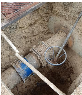
Figura N°58. Válvula mariposa de la tubería Bypass de la válvula P.
