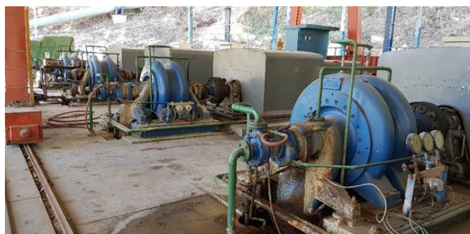
Figura N°24. Bombas 5, 4, 3 y 2 de las cinco que forman parte del Grupo de bombeo Sur.
