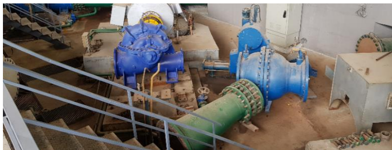
Figura N°45. Ramal de bombeo número 4, grupos Norte E/B 25.
