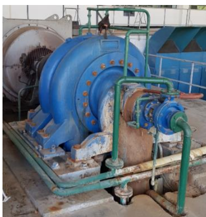
Figura N°50. Bomba centrífuga KSB HE 250-62 del Grupo de bombeo Sur.
