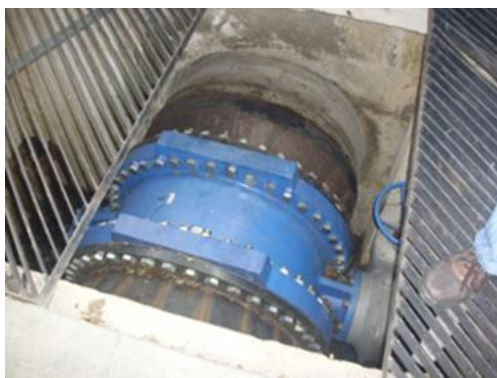
Figura N°26. Válvula mariposa del Alimentador Este conocida como la “Compuerta del Este”.
