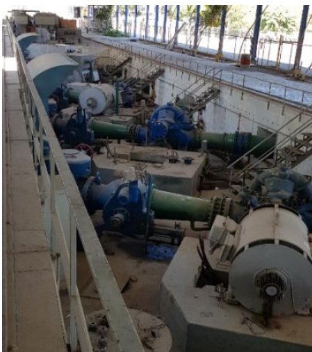
Figura N°25. Bombas que forman parte del Grupo de bombeo Norte.
