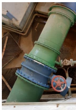
Figura N°37. Tubería principal de entrada al ramal, válvula mariposa, contracción y tramo de tubería antes de la bomba del ramal número 3.
