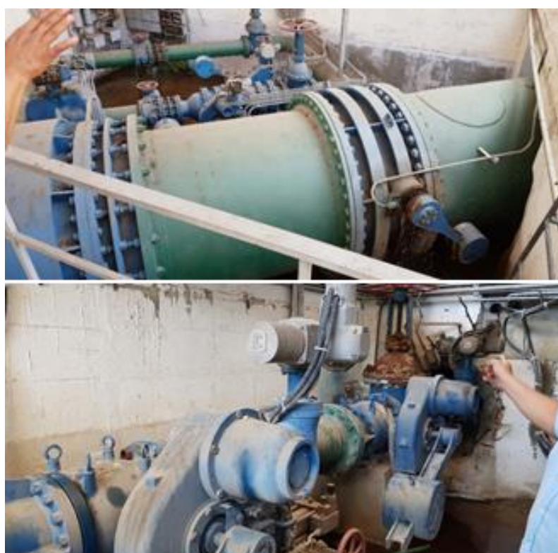
Figura N°27. Dispositivos disipadores de Golpe de Ariete del Grupo de bombeo Norte y del Grupo de bombeo Sur respectivamente.
