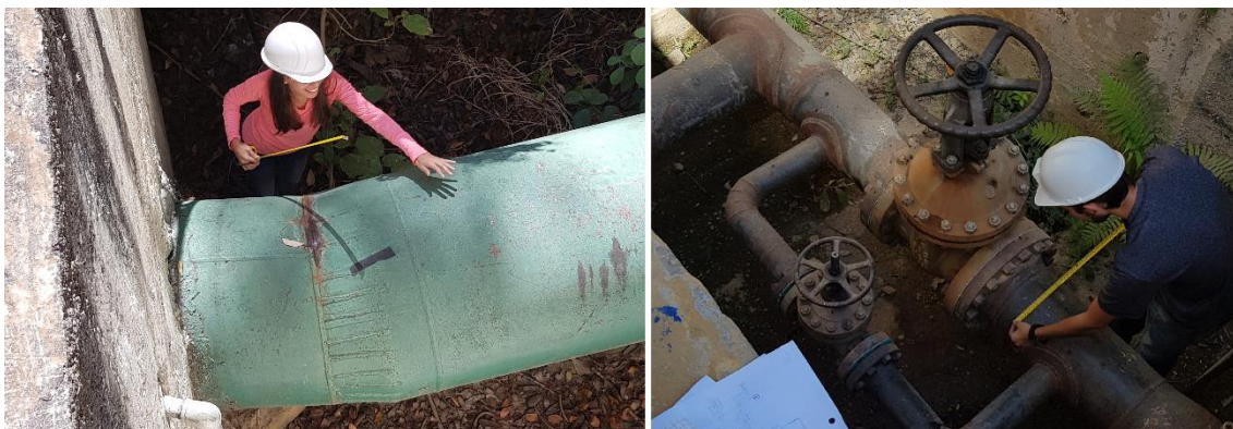
Anexo N°6. Comprobación aproximada de algunos diámetros externos de tubería dentro de la E/B 25 por los autores de este trabajo.
