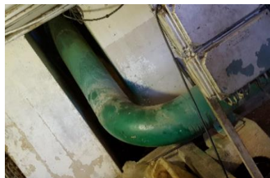
Figura N°52. Tramo de tubería con codo a 90° del ramal número 1.
