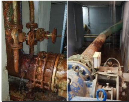
Figura N°55. Estado de las tuberías antes y después de la bomba del ramal número 5, grupos Sur E/B 25.
