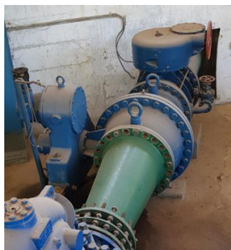
Figura N°38. Expansión, válvula de paso anular, válvula mariposa y tubería principal de salida al Alimentador Norte del ramal número 3.
