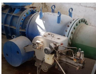
Figura N°47. Válvula de paso anular VAG RIKO del ramal número 5.
