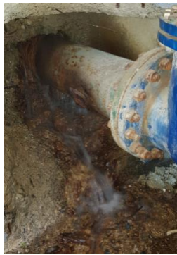
Figura N°56. Fuga de agua en la convergencia entre el ramal número 5 y el Alimentador Sur.
