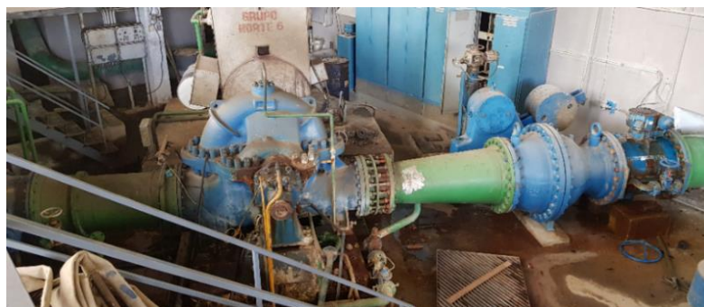
Figura N°40. Ramal de bombeo número 1, grupos Norte E/B 25.
