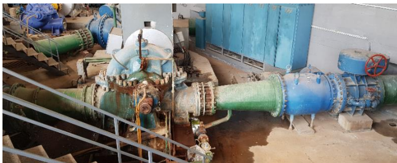
Figura N°48. Ramal de bombeo número 5, grupos Norte E/B 25.
