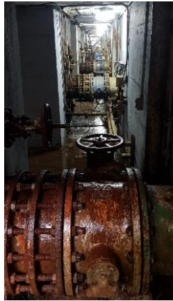
Figura N°51. Tramo de succión de los cinco ramales, se pueden apreciar las cinco válvulas mariposa siendo la más visible la del ramal número 5.
