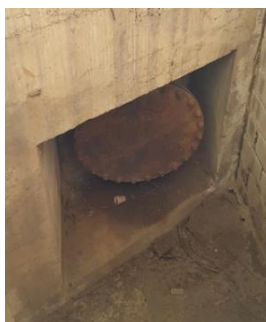
Figura N°33. Uno de los ramales construidos y fuera de operación, pertenecientes a los grupos de bombeo Norte.
