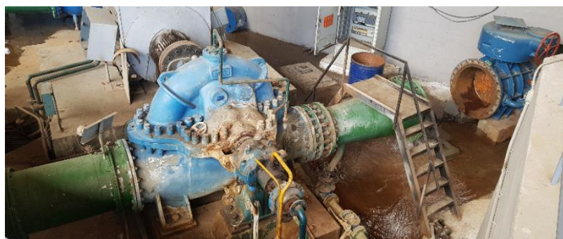
Figura N°49. Ramal de bombeo número 6, grupos Norte E/B 25.
