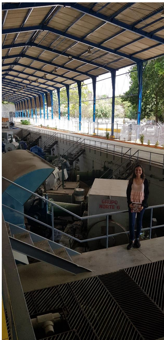
Anexo N°9. Estación de bombeo E/B 25 Norte.
