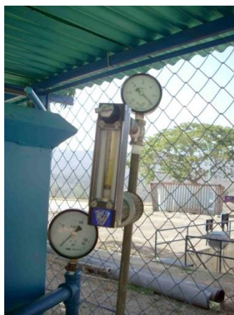
Imagen N° 13 Manómetros de presión de saturación y vacío de succión, rotámetros caudal aire
