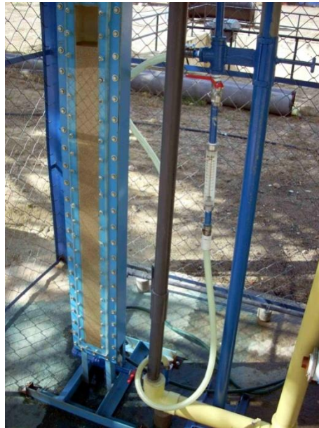
Imagen N° 11 Filtro de arena
