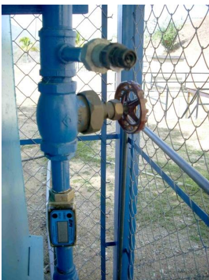
Imagen Nº 8 Medidor del volumen de entrada de agua
