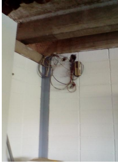
Exposición de cableado eléctrico
