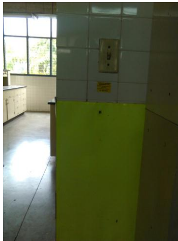
Ausencia de extintor portátil.
