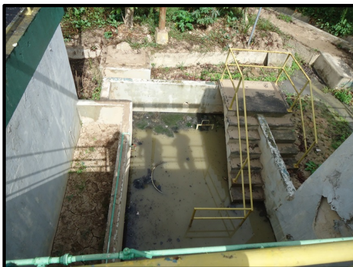
Inundación sistema de desbaste y pozo de bombeo.
