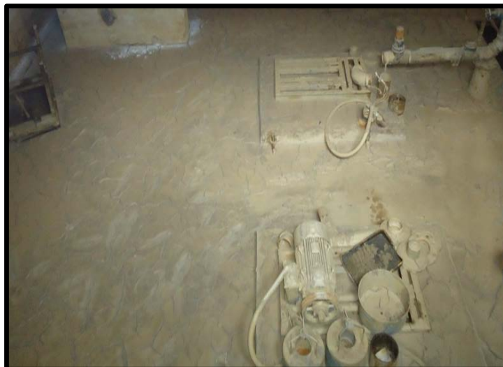
Inundación sala de bombas.
