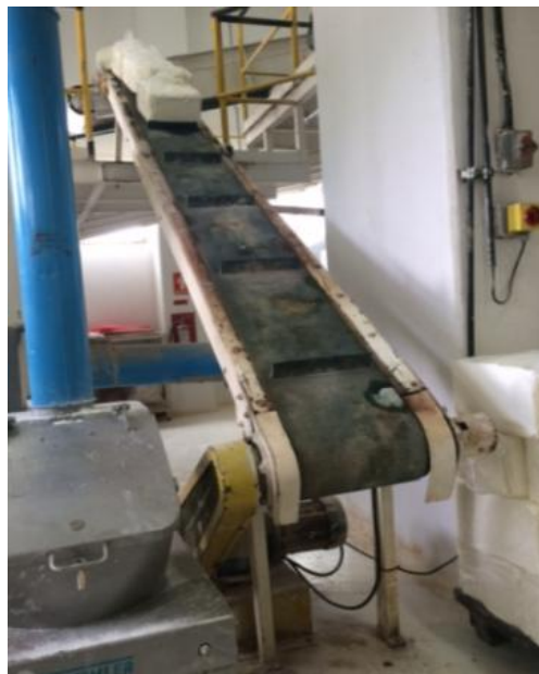
Cinta transportadora piso 4. Fuentes: Elaboración propia.
