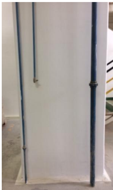
Punto de conexión manguera hidráulica piso 3
