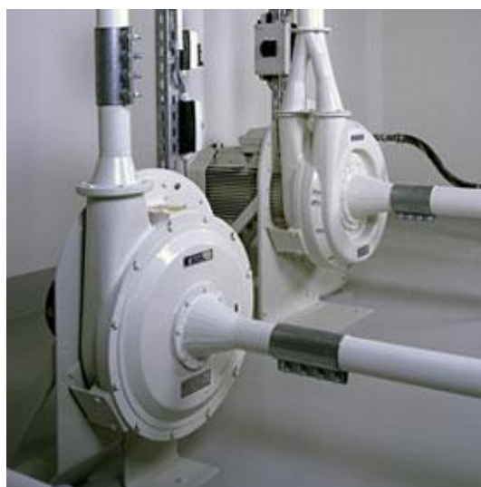
Ilustración 18: Desinfestadoras Fuentes: Elaboración propia
