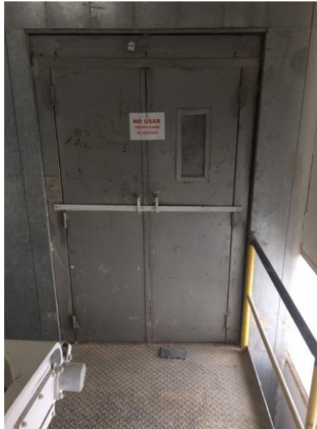
Ascensor piso 4. Fuentes: Elaboración propia
