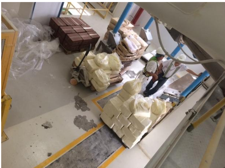
Estado actual del piso epóxico de piso 4. Fuentes: Elaboración propia
