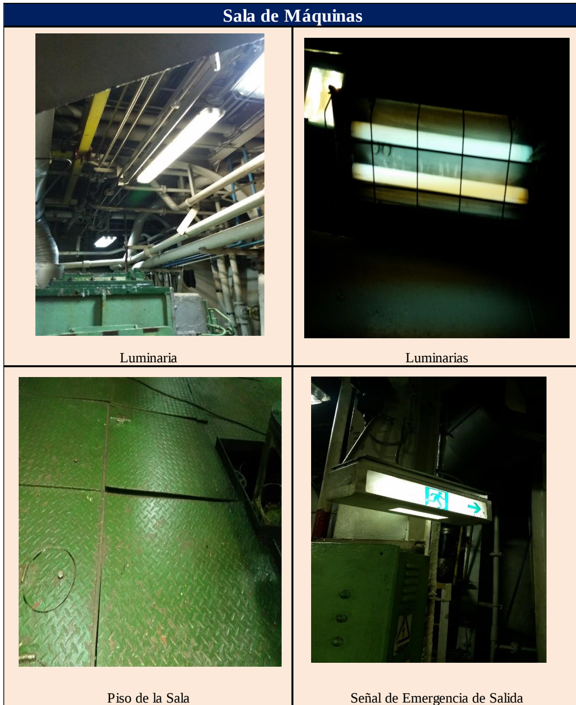
Figura 38 Fotos de Pisos e Iluminarias en Sala de Máquinas
