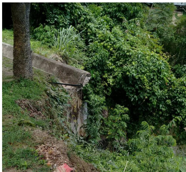
Ilustración 23. Deslizamiento del talud de la margen izquierda (2). Zona, parque la trinidad. Sector IV Fuente: Propia
