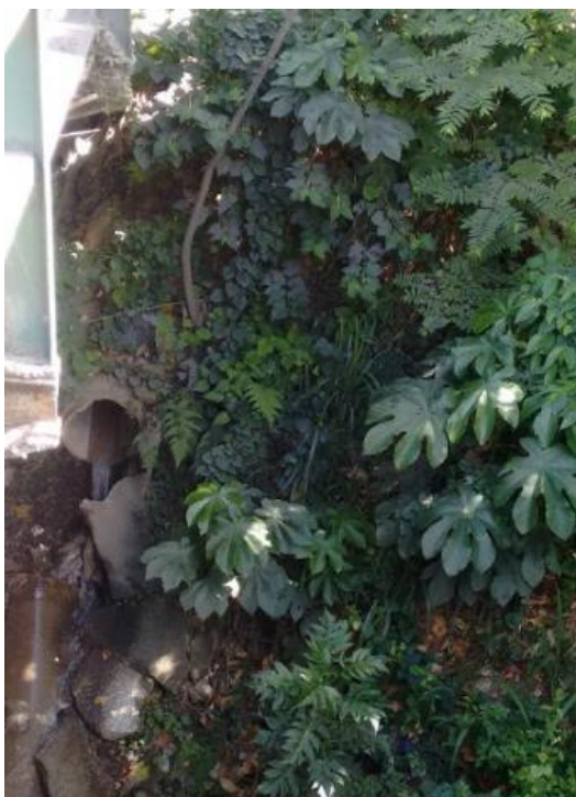
Ilustración 27. Punto de descarga de agua residual a la altura del C.C. Plaza las Américas. Sector IV Fuente: Propia
