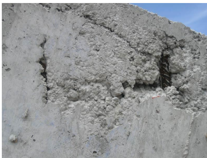
Figura 26. Falla por falta de vibrado en el concreto.
