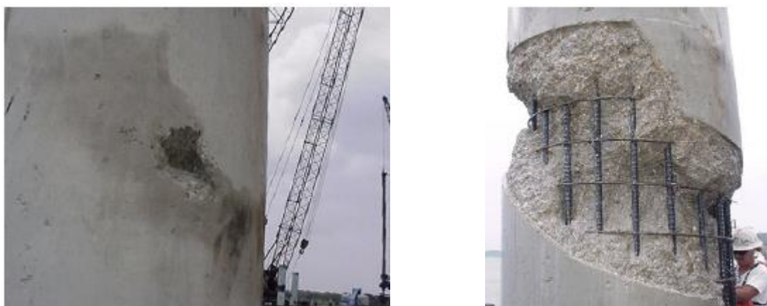
Figura 25. Falla por asentamiento del concreto.
