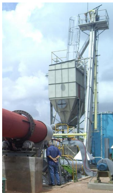
Figura 12 Soplador secundario, enfriador, canjilón y Silo
