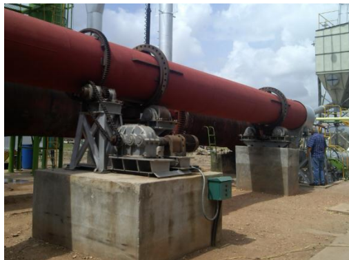
Figura 10 Soportes de Cojinetes del horno de la empresa CALCA
