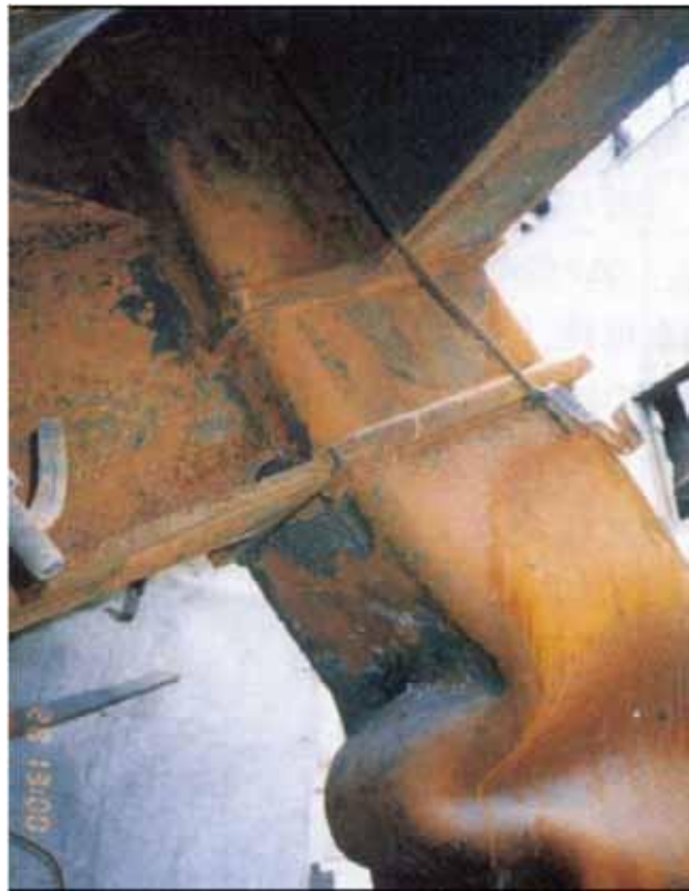
Figura I.5 Conexión típica en Japón 1995, pandeo local de la columna
