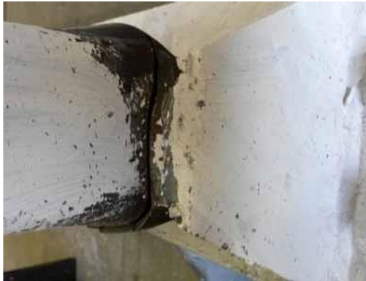
Figura VI.27 Agrietamiento final del ala del perfil tubular rectangular usado como viga. Ensayo #1
