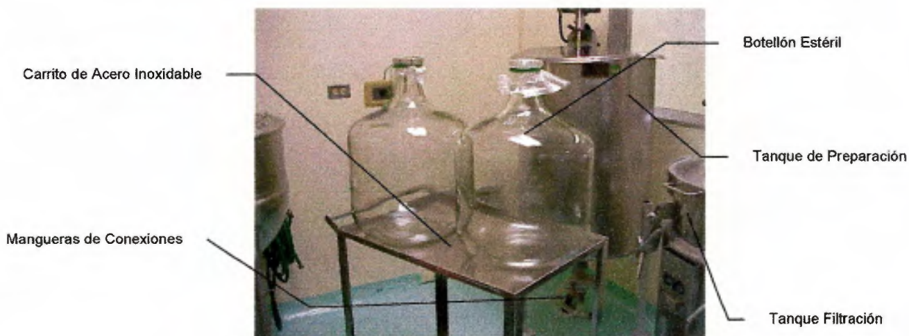
FOTO 5: UBICACIÓN DE LOS BOTELLONES Y EQUIPOS PARA LA FILTRACIÓN DE LA SOLUCIÓN
