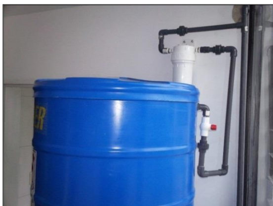
Figura 18. Tanque de Agua + Bomba + Sistema Hidroneumático
