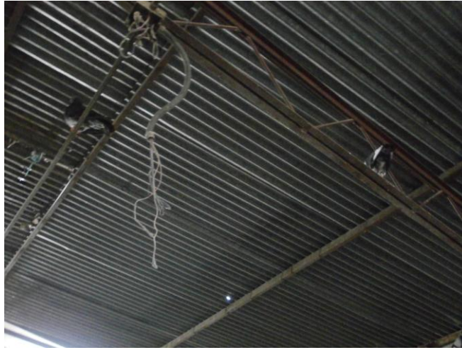
Figura 8. Techos con Agujeros y Presencia de Palomas en Piso 2
