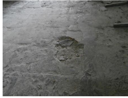
Figura 10. Pisos con Imperfecciones (Agujeros o Roturas) Fuente: Elaboración Propia
