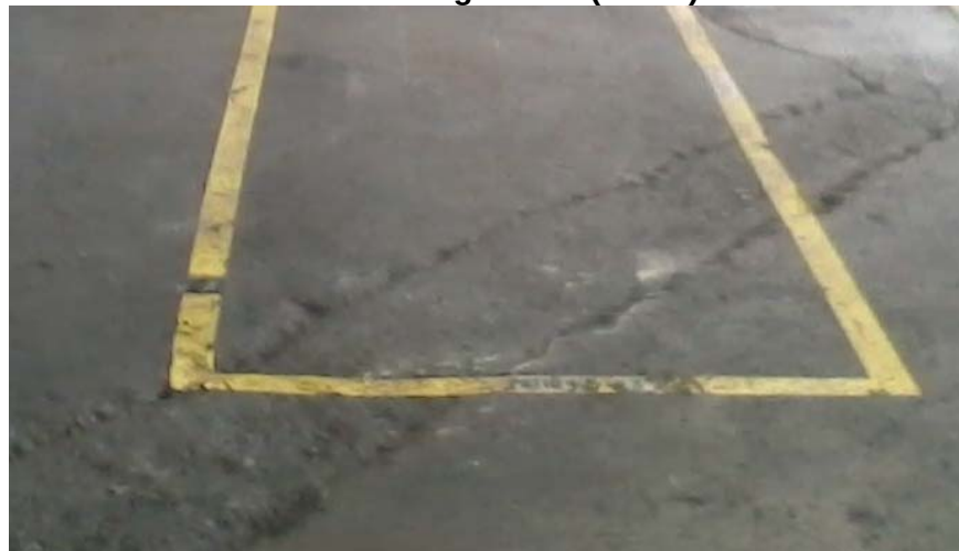
Ilustración Nro. 22. Piso Agrietado ( Patio) Almacén 3
