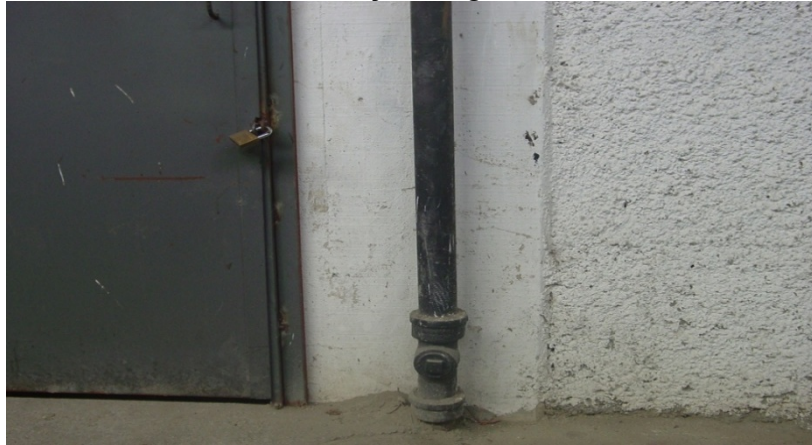
Ilustración Nro. 18. Almacén Pulmón 2 Tuberías y Desagues
