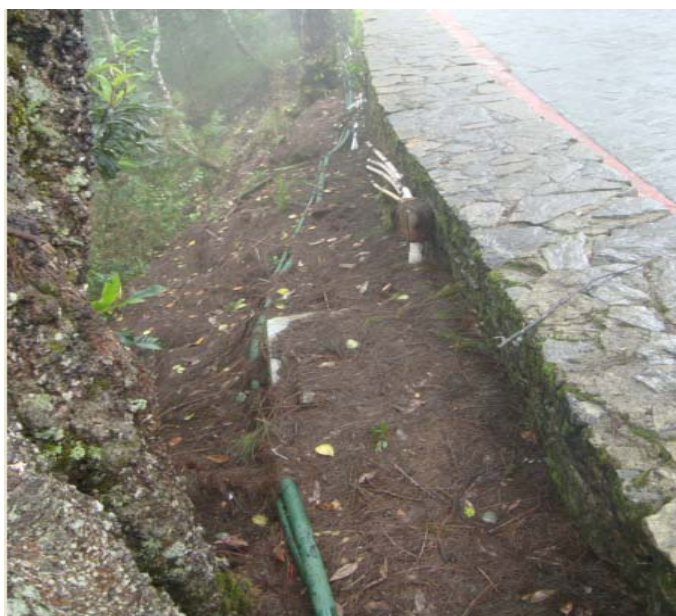
Figura 30. Cableado eléctrico Parque “Warairarepano”.
