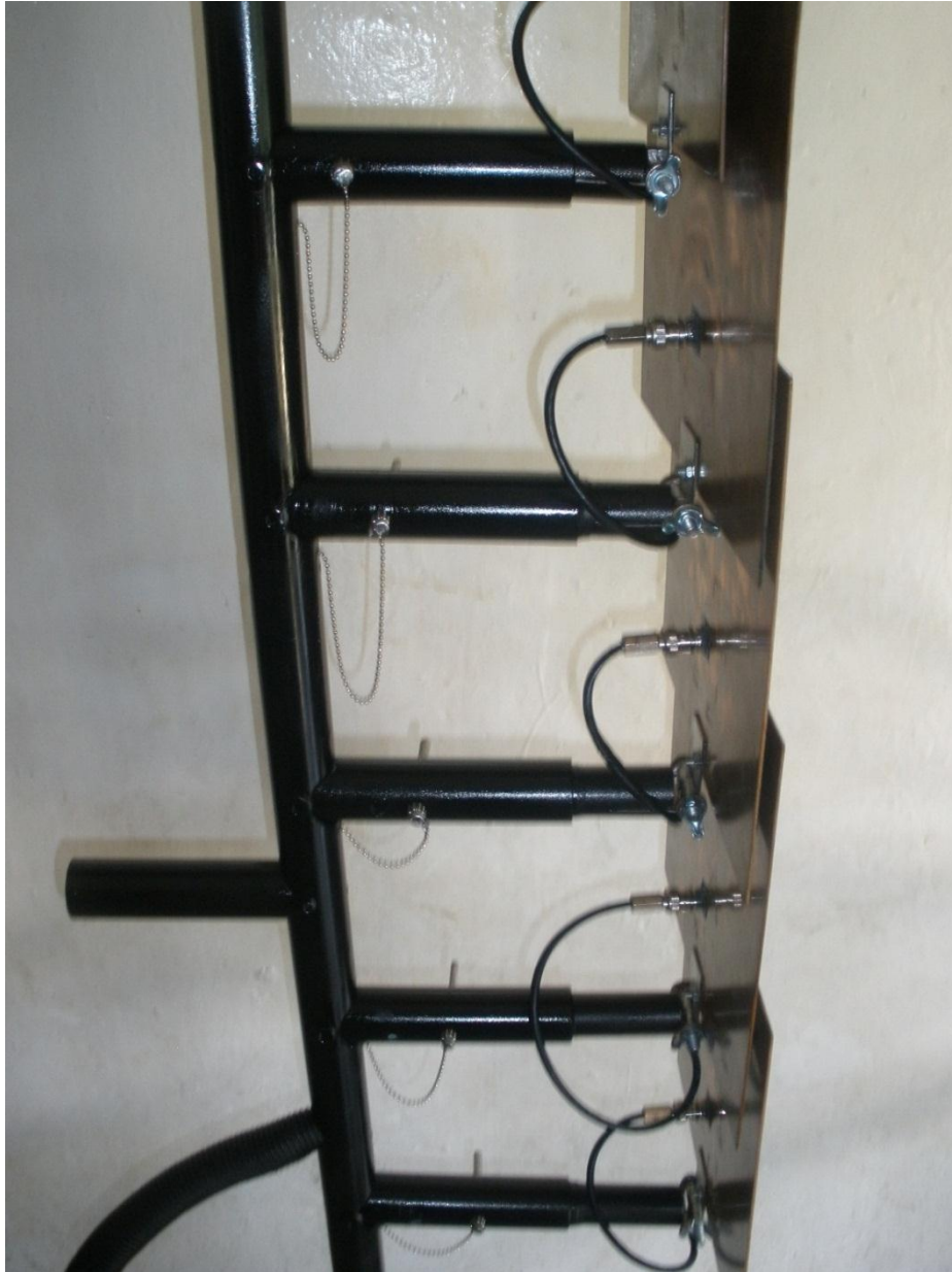
Figura 21. Separación entre antenas. Fuente: Elaboración propia.
