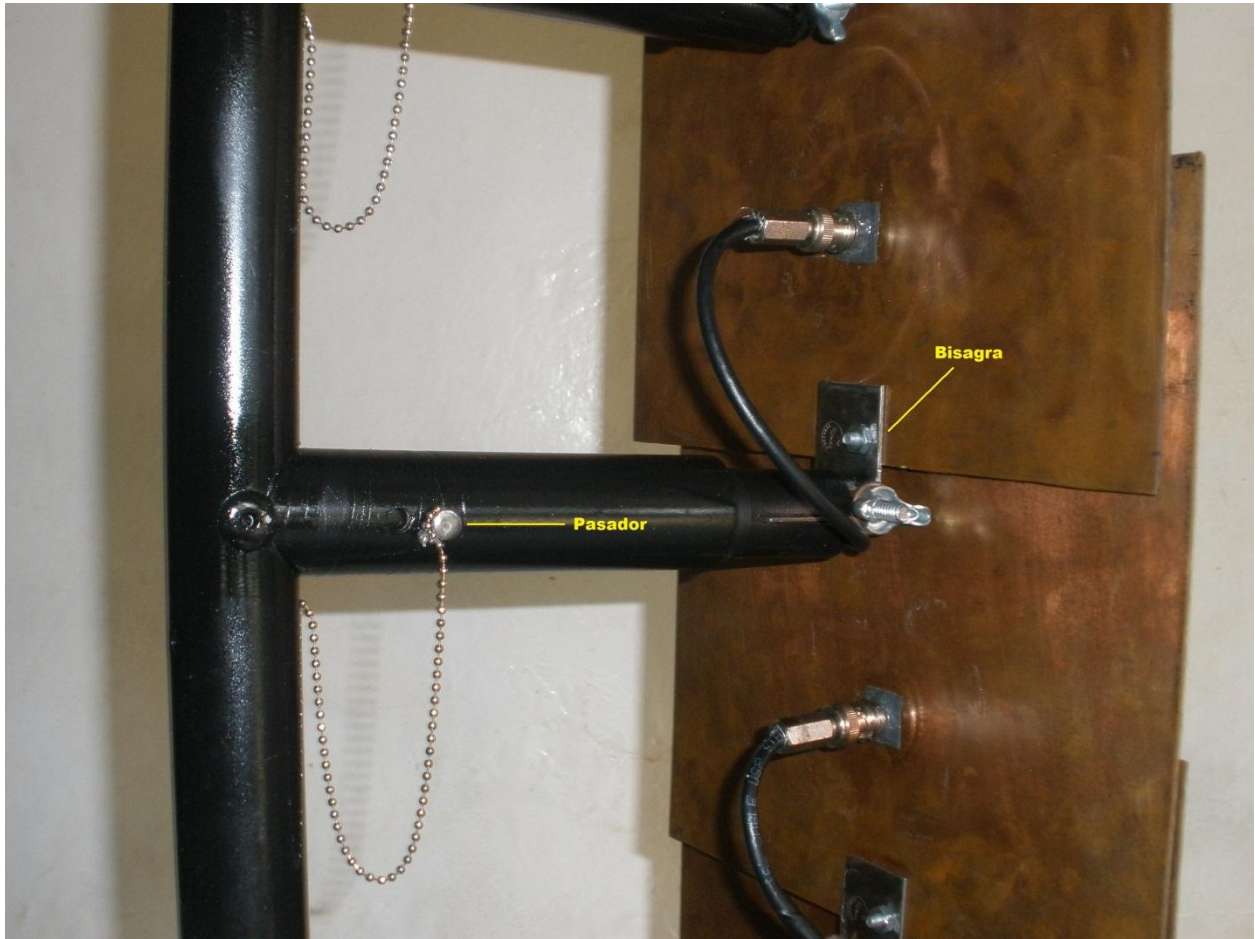
Figura 20. Soporte de una antena. Fuente: Elaboración propia.
