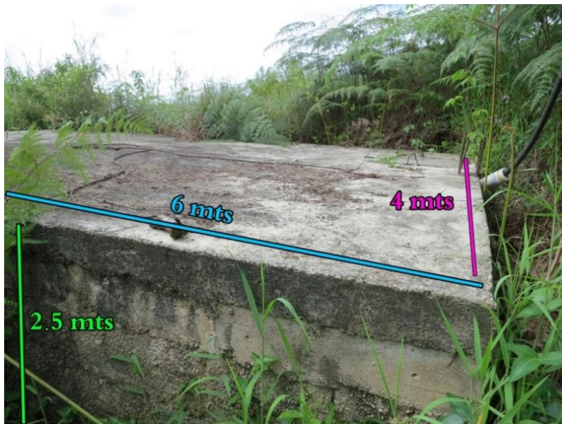
Ilustración 18: Tanque principal de agua Finca el Pinar con medidas Fuente: Elaboración Propia
