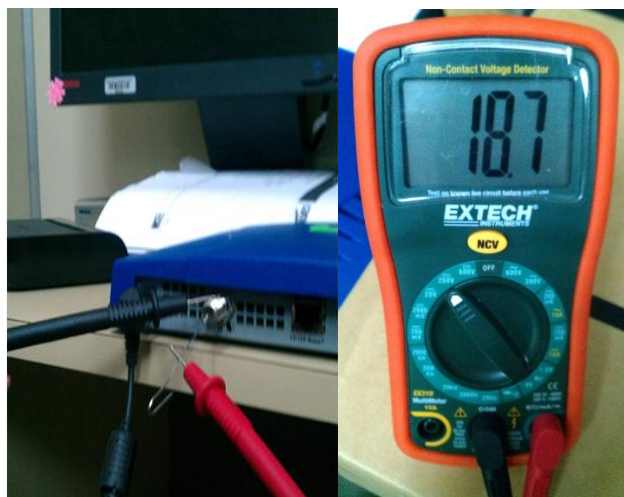
Figura 23 Voltaje de Rx en el modem de la primera cadena
