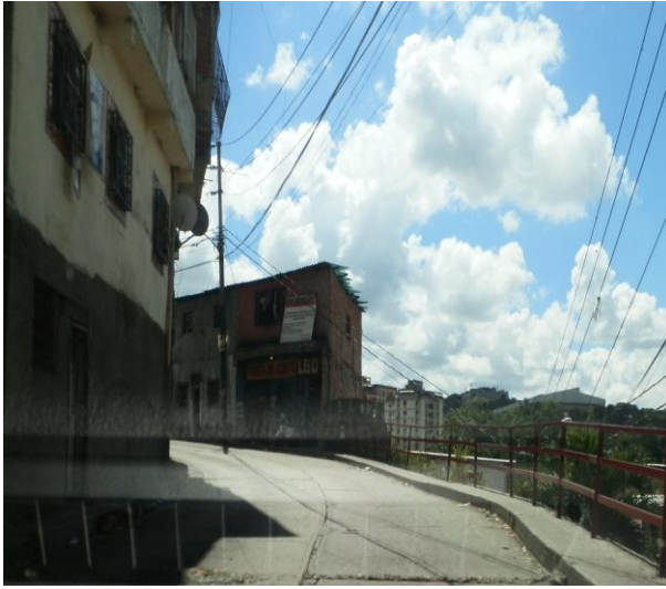
Foto 5. Calle Caruto, calzada de pavimento rígido con escalonamiento y fisuras.
