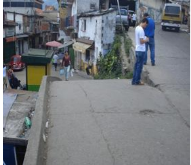
Foto 4. Empalme a desnivel de la calle Caruto con Calle La Línea, presencia de pavimento rígido en malas condiciones y calzadas estrechas.
