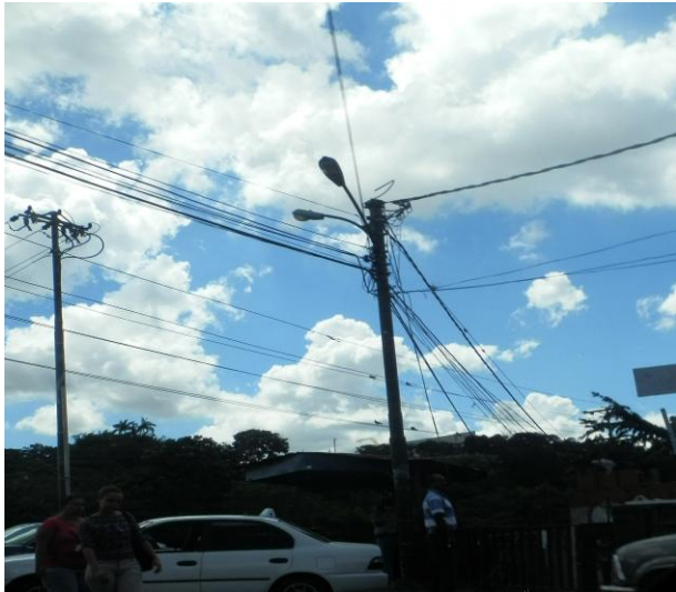
Foto 25. Puente Baloa, luminaria lateral de dos brazos.
