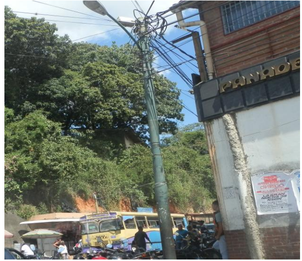
Foto 6. Intersección I-2, luminaria lateral con un brazo.
