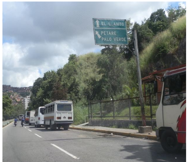
Foto 26. Av. Río de Janeiro, señalización de información direccional en mal estado de conservación
