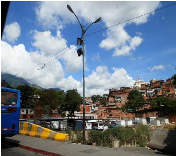
Foto 7. Puente Baloa, presencia de luminaria lateral de doble brazo con reflectores adicionales debido a la baja iluminación presente en el sector Petare - Sur
