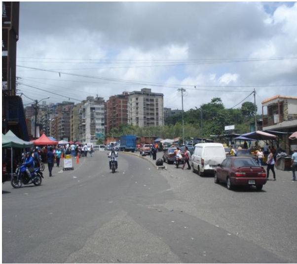
Foto 5. Calle Federación en intersección I-2, extremo de las calzadas presencia del comercio informal, pavimento flexible con Ahuellamiento y baches.
