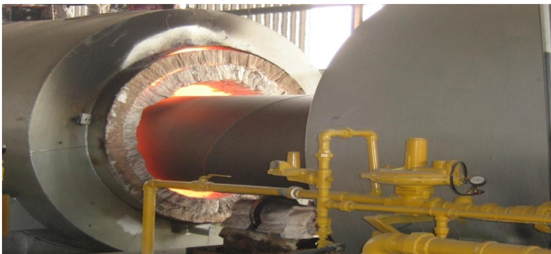
Figura 12: Salida del tubo del horno de calentamiento.
