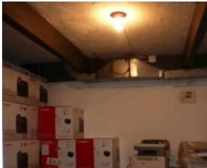
Iluminación Almacén “D03”
