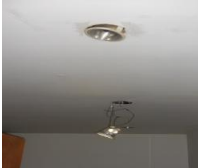
Iluminación Almacén “D02”
