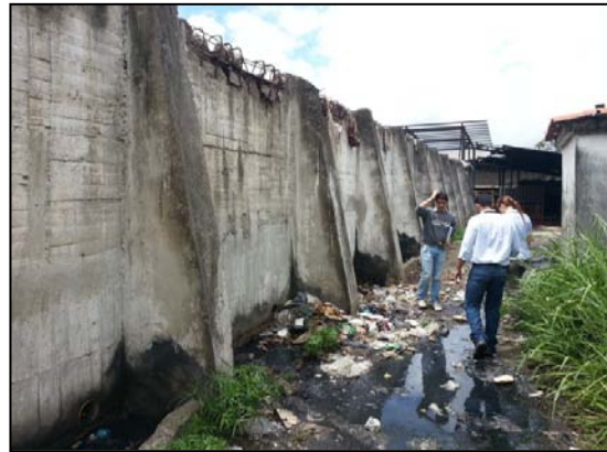
Disposición inadecuada de los lixiviados
