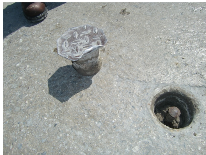
FIGURA 3.4.1.1.b.: Protección superficial de una placa de asentamiento.
