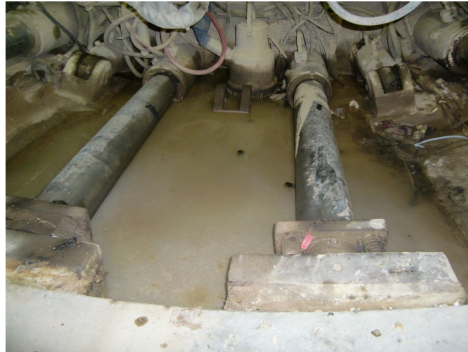
FIGURA 2.3.1.2.e.: Gatos hidráulicos TBM-EPBs del Proyecto Línea 5 del Metro de Caracas.
