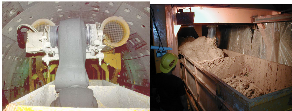
FIGURA 2.3.1.2.d.: Banda transportadora descargando el material al contenedor.
