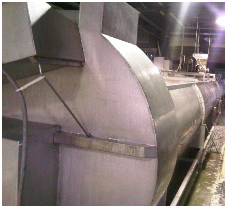
Figura 49.- Chiller. Fuente: Cámara fotográfica.
