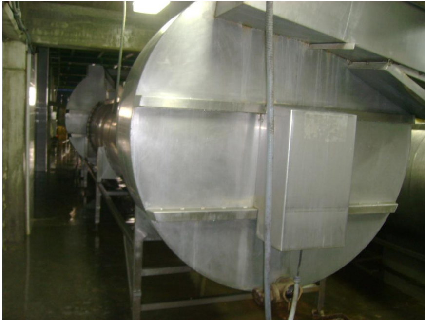
Figura 48.- Pre – Chiller II. Fuente: Cámara fotográfica.
