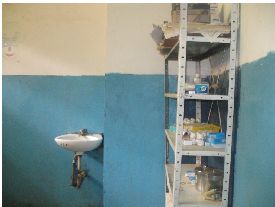
Anexo 23: Interior del dispensario de Paracacualito. En el estante hay medicinas vencidas.
