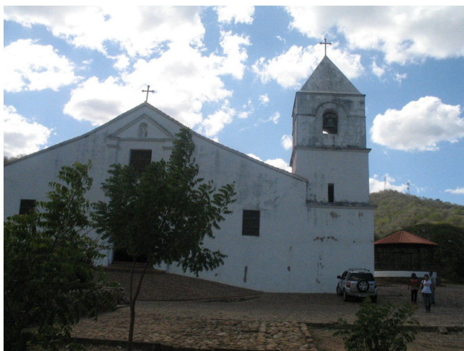
Anexo 2: Capilla con las paredes desconchadas.
