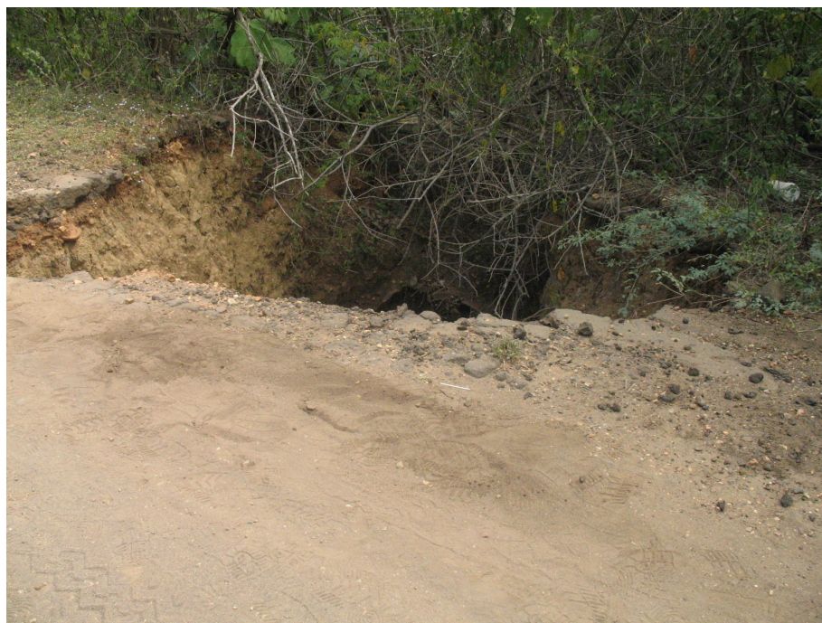
Anexo 5: Hueco en la carretera que conduce a Campo Alegre.
