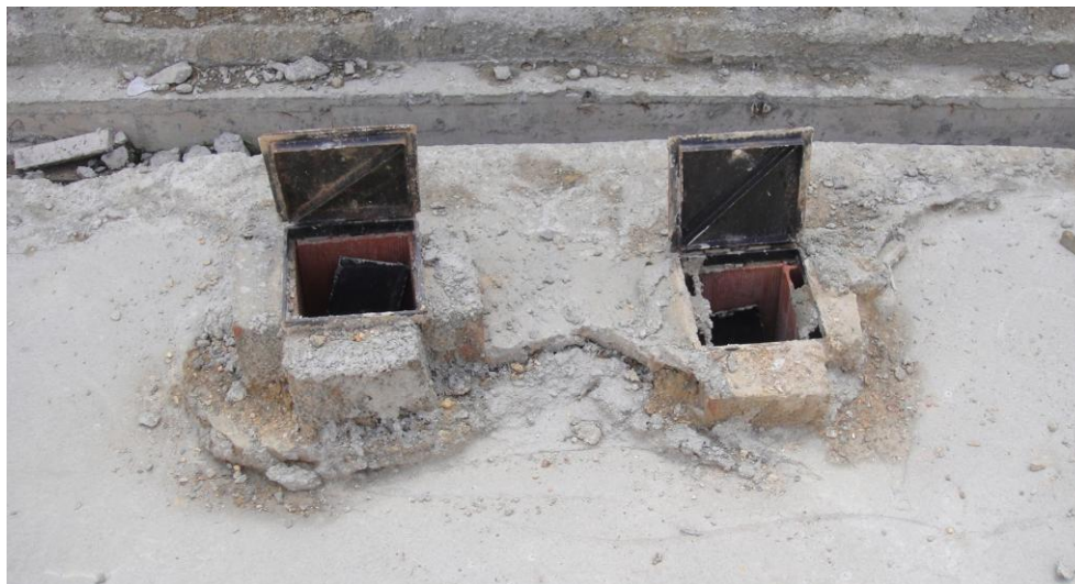
Cabezal para colocación de tasómetro y piezómetro
