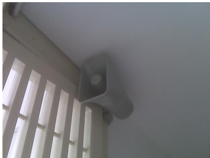
Figura 20.-Parlante de la alarma contra incendios. Fuente: Elaboración Propia
