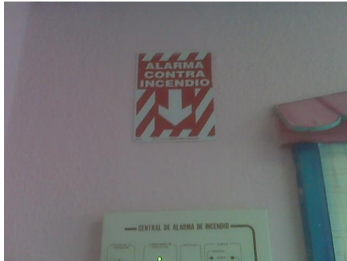
Figura 15.- Señal de Alarma Contra Incendio. Fuente: Elaboración Propia
