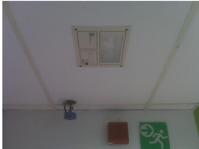
Figura 29.- Lámparas de Emergencia del área de básica. Fuente: Elaboración Propia
