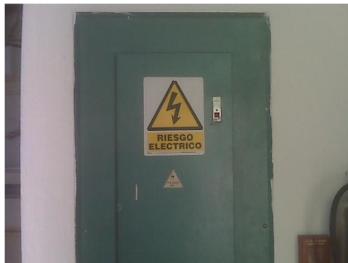
Figura 14.- Señal de advertencia (Riesgo Eléctrico). Fuente: Elaboración Propia
