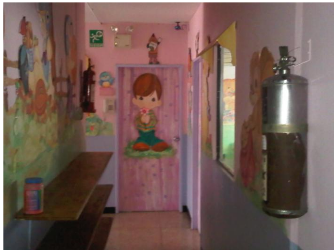
Figura 44.- Señalización, Lámpara de emergencia y extintores en el piso 1 del preescolar. Fuente: Elaboración Propia
