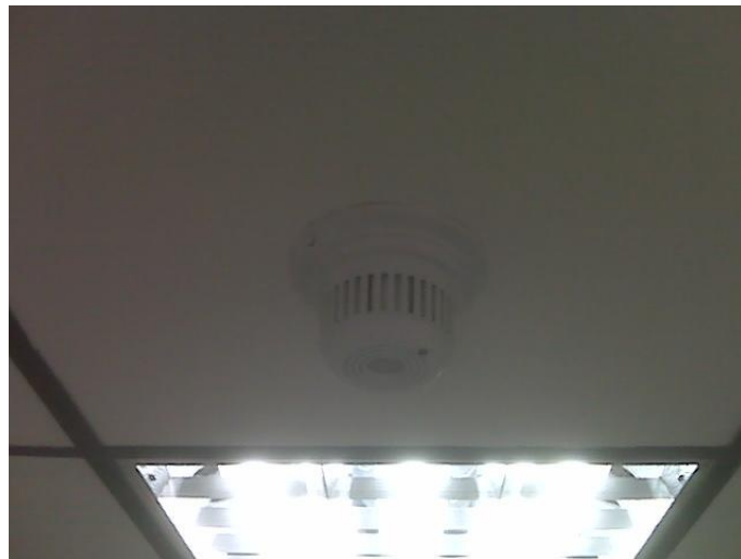
Figura 21.-Sistema de detección de incendios. Fuente: Elaboración Propia
