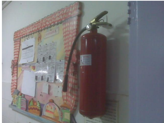
Figura 17.- Extintor contra incendios ubicado en el área de preescolar. Fuente: Elaboración Propia
