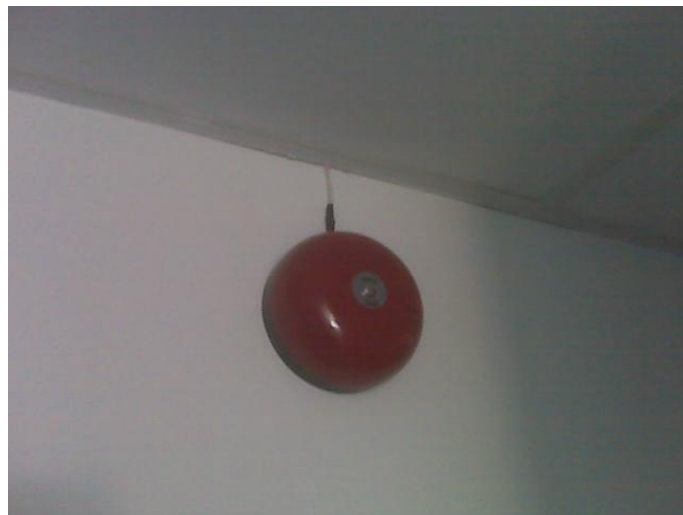
Figura 30.- Alarma contra incendio. Fuente: Elaboración Propia
