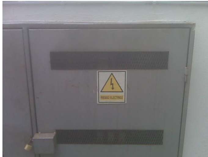
Figura 19.- Señal de advertencia (Riesgo Eléctrico) del cajetín principal de electricidad. Fuente: Elaboración Propia
