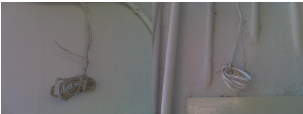
Figura 39.- Cableado que genera condición insegura. Fuente: Elaboración Propia.
