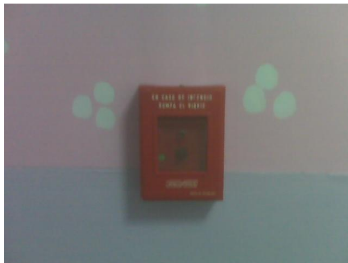
Figura 16.- Estación Manual – Sistema de Seguridad Contra Incendio. Fuente: Elaboración Propia
