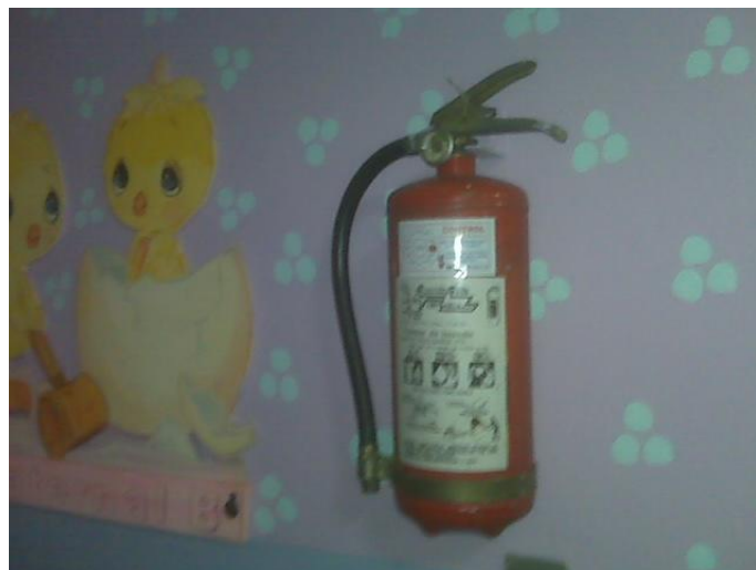
Figura 24.- Extintor contra incendios ubicado en el área de preescolar con sus respectivas instrucciones en español. Fuente: Elaboración Propia
