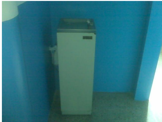
Figura 43.- Bebedero de agua potable. Fuente: Elaboración Propia
