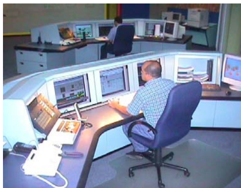
Fotografía 1. Sala de control del Sistema Centro de Control de EDELCA
