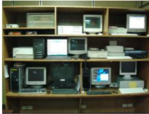
Fotografía 3. Registradores de fallas del Sistema Centro de Control de EDELCA
