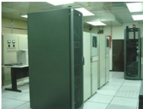
Fotografía 4. Sala de Servidores del Sistema Centro de Control de EDELCA
