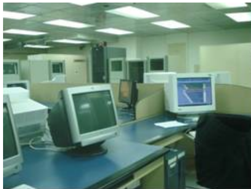
Fotografía 5. Sala de Mantenimiento del Sistema Centro de Control de EDELCA
