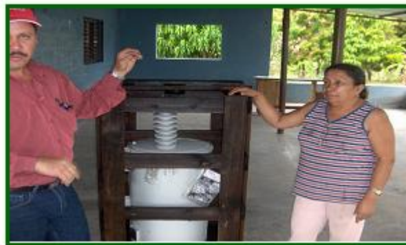
Donación de Un transformador a la Comunidad de Orocal de los Mangos, producto del diagnostico comunitario participativos.
