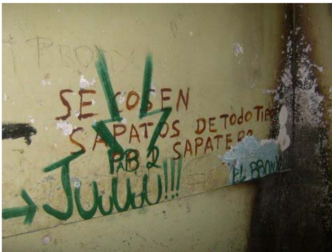
Pared que da hacia las escaleras del pabellón 1 del I.J. de Los Teques
