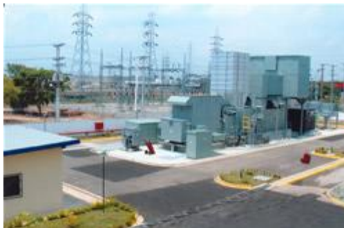
Figura 4-4 Foto de una subestación Eléctrica
