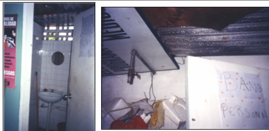
FOTOS DEL SANITARIO ESPACIO INSALUBRE
