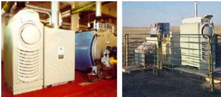
Figura 8. Equipos de Microturbinas. (Fuente: www.enerdis.com )
